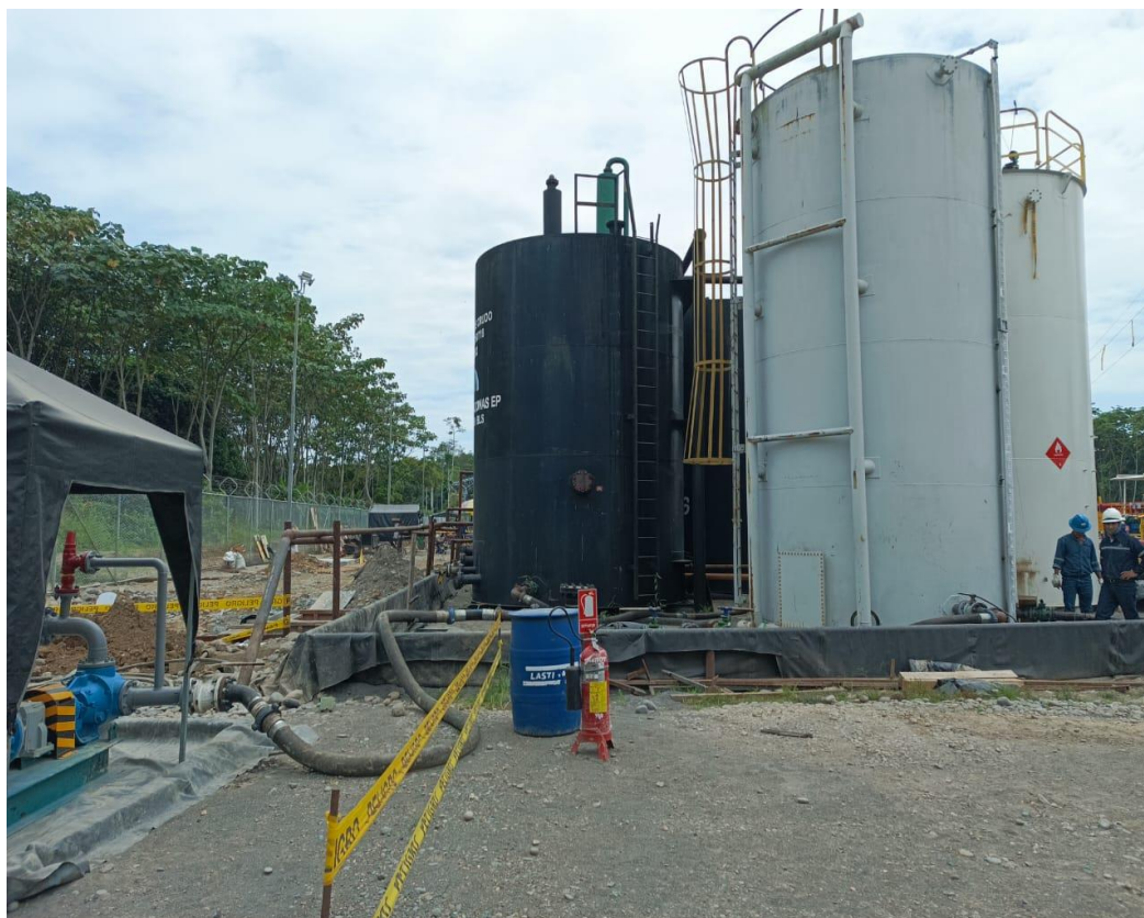
Figura 40.- Tanques donde se realiza la mezcla de los pozos 08-28-29
