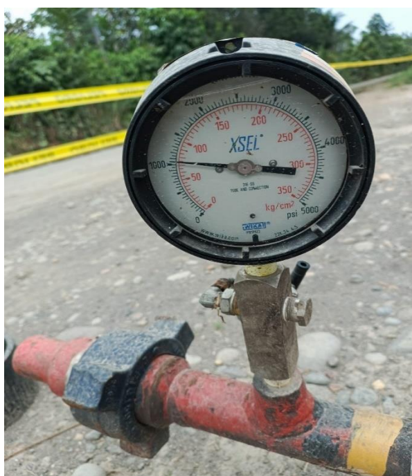
Figura 44.- Presión de descarga de la bomba UBH
