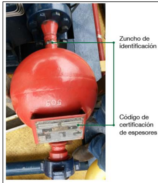
Figura 25.- Damper instalada en el UBH
