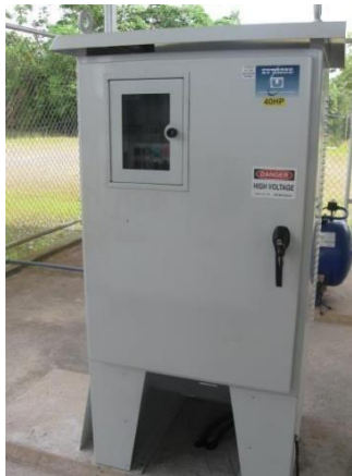
Figura 12: Gabinete con el Variador
