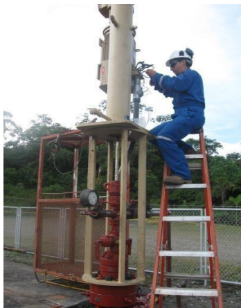
Figura 13: Conexión eléctrica del motor AC de la unidad LRP.
