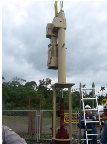
Figura 11: Unidad LRP instalada
