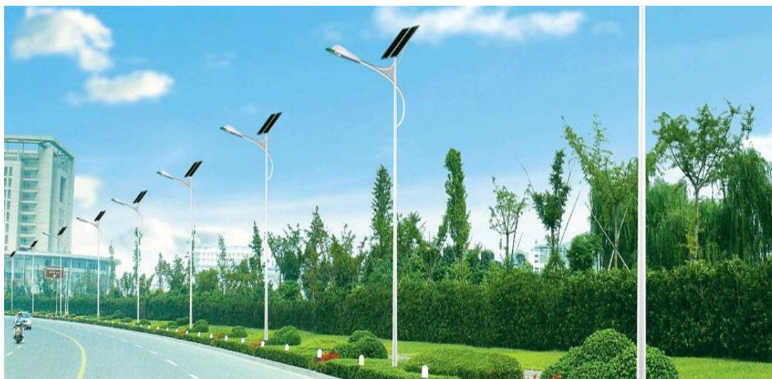
Figura 2. Sistema de iluminación led-solar
