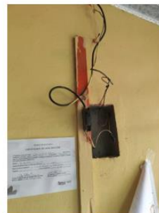
Revisión de caja de distribución
