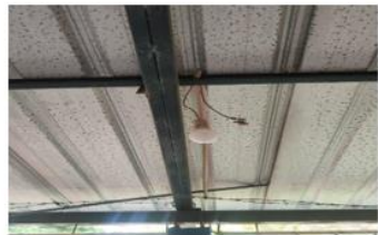
Foco y boquilla en mal estado
