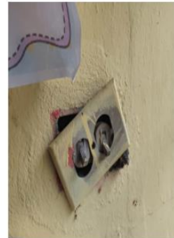
Interruptores en mal estados
