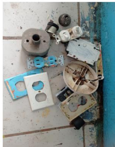
Material eléctrico defectuoso
