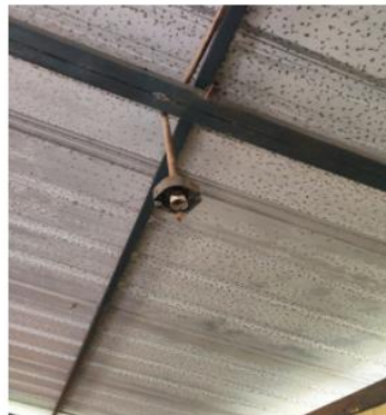
Boquilla y caja octagonal oxidadas
