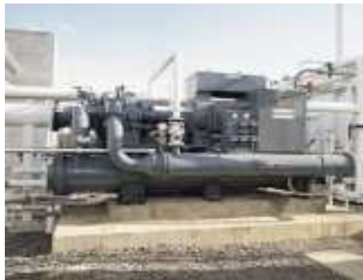
Figura 6 Compresor de Nitrógeno
