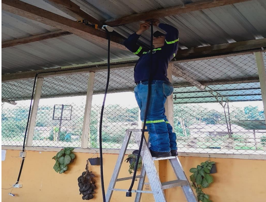
Canalización para circuitos de iluminación
