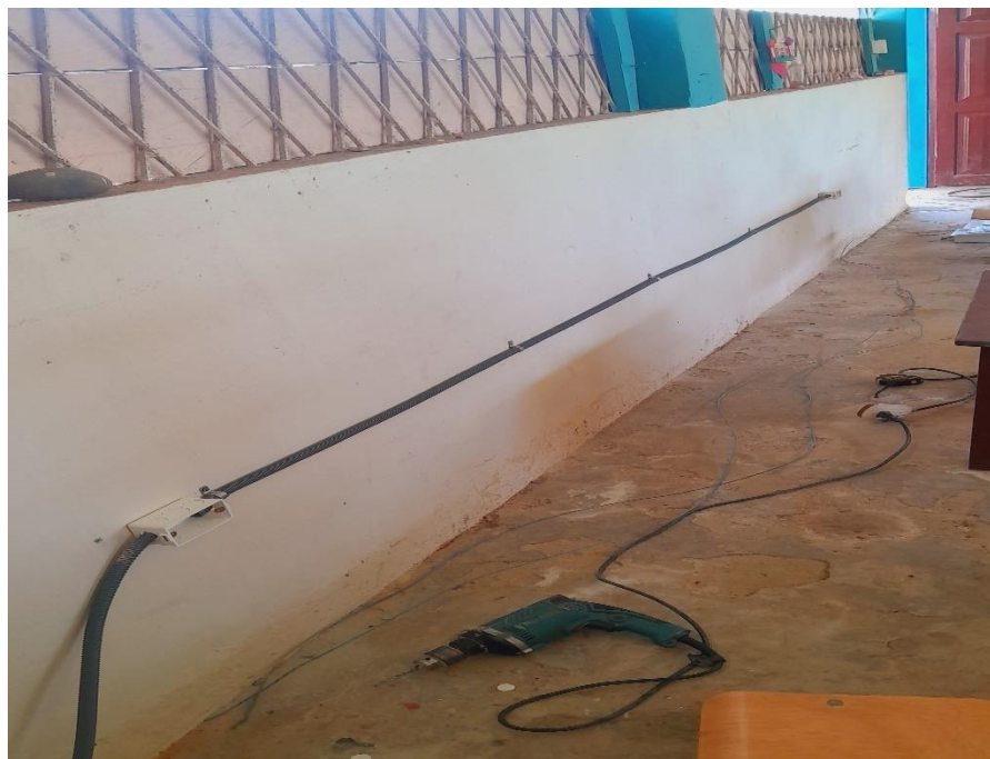
Canalización para circuito de tomacorrientes
