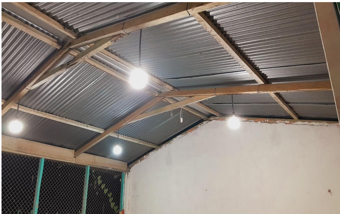
Iluminación con 4 foco de 40 W-aula 4
