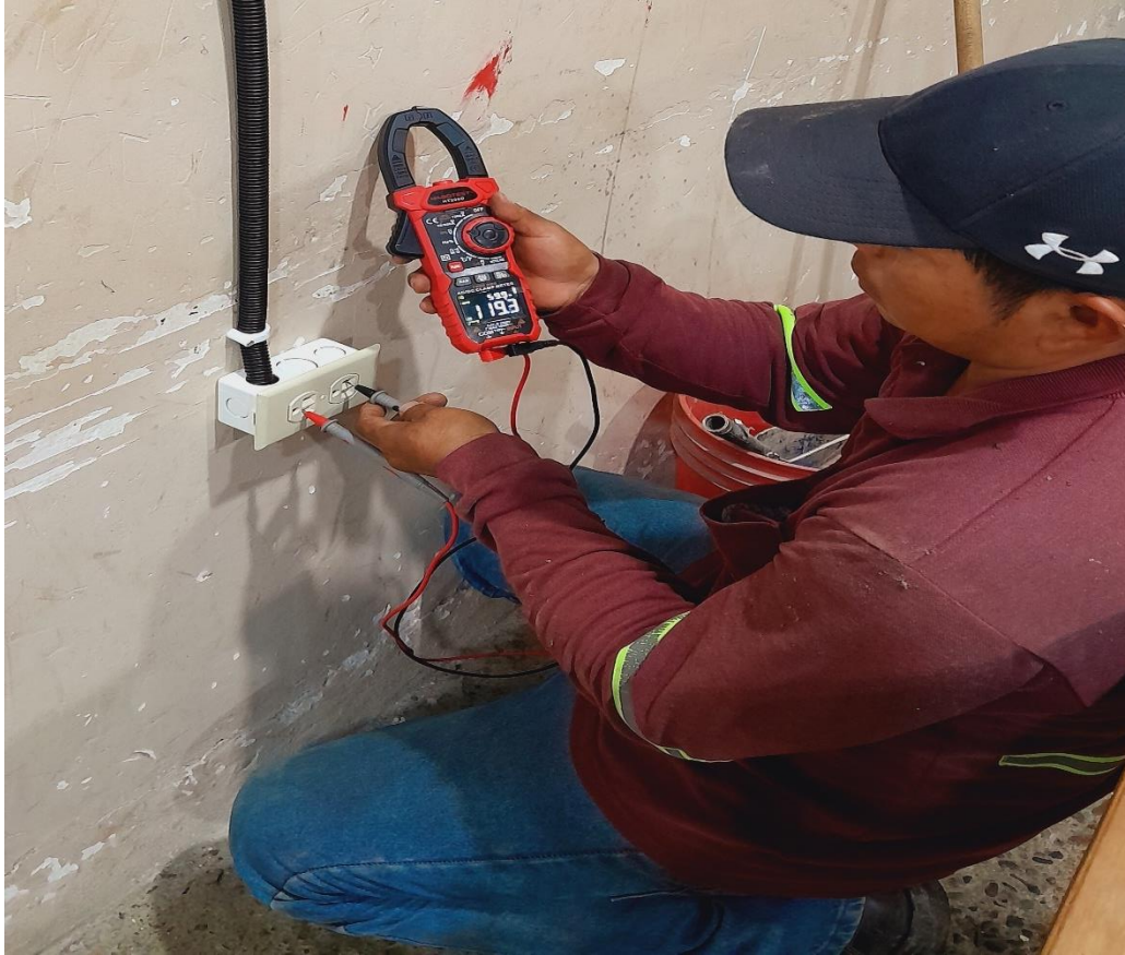
Medición con la pinza amperimétrica en el tomacorriente teniendo un voltaje de 119 V.
