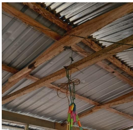
Figura 9. Conexiones eléctricas obsoletas.
