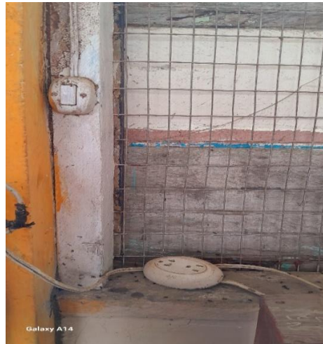
Figura 8. Interruptores y tomas en mal estado.
