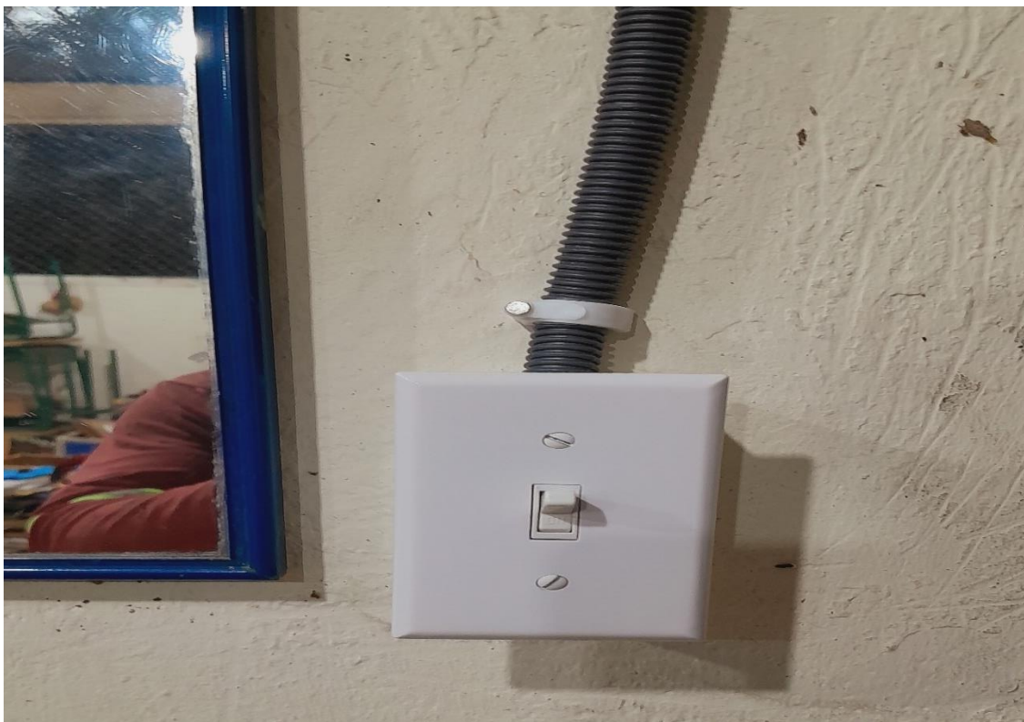
Interruptor instalado para un circuito de iluminación
