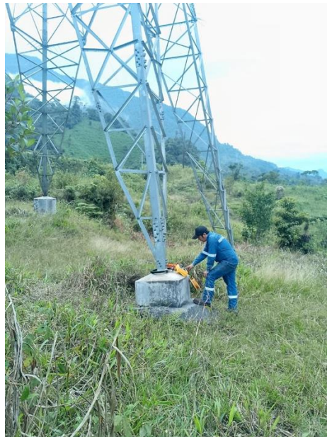
Medición de puesta a tierra de la torre
