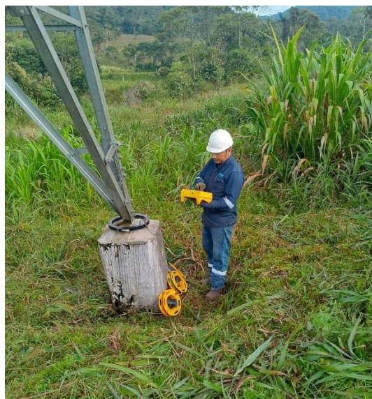
Figura 16. Medición de la resistividad del suelo.
