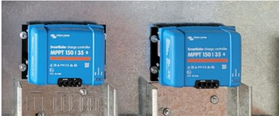
Figura 7.- Reguladores de tipo AC/DC, instalados en el sistema de regulación. Fuente: Propia
