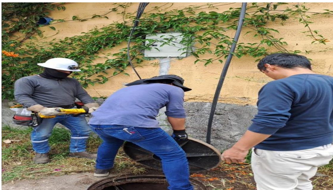
Figura 38.- Derivación de la Alimentación aérea hacia la Instalación Soterrada. Fuente: Propia
