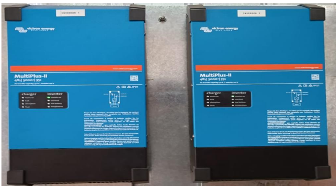
Figura 6.- Inversores de Energía Instalados en el sistema de transformación. Fuente: Propia
