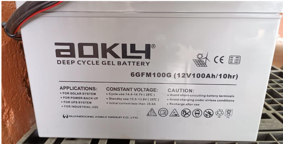
Figura 5.- Batería de Gel, Instalada en el sistema de respaldo. Fuente: Propia
