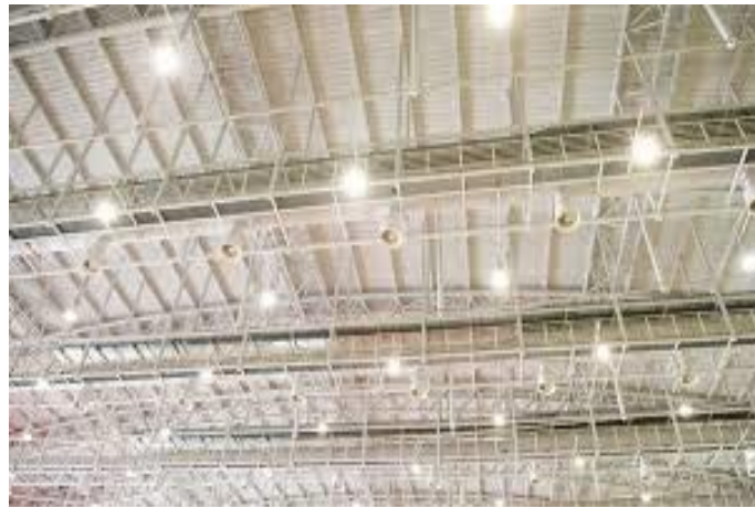
Figura 4. Sistema de Iluminación
