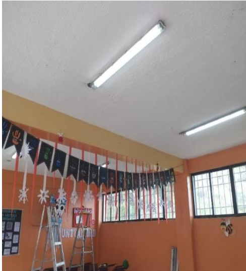
Figura 4.8. Luminarias encendidas sin novedad
