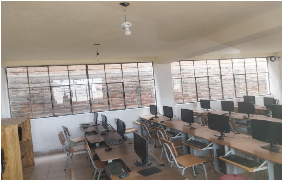
Figura 3.67. Luminaria instaladas Centro de Computo
