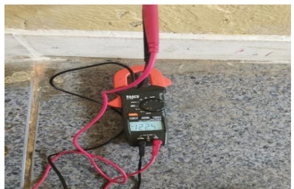
Figura 4.4. Medición con multímetro de voltaje 122vac
