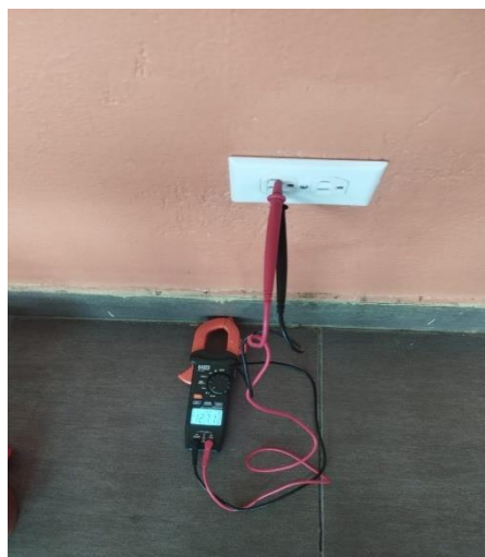
Figura 4.23. medición de voltaje en puntos de fuerza 120 V
