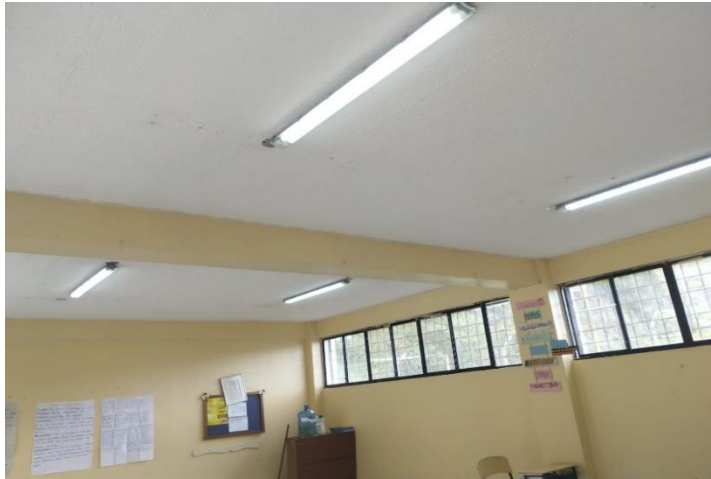
Figura 4.1. Encendido de luminarias sin novedad.
