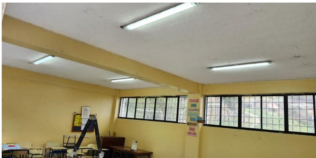
Figura 3.60. Luminarias instaladas aula 3
