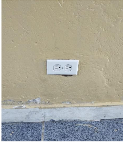
Figura 4.6. Punto de fuerza con Funcionamiento
