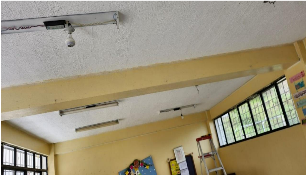
Figura 3.57. Luminarias anteriores aula 3
