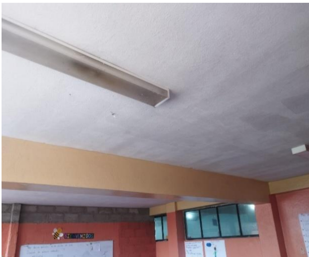
Figura 3.75. Luminarias instaladas aula 6
