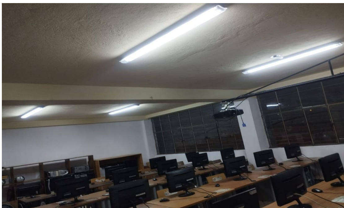
Figura 3.73. Luminarias instaladas Centro de computo
