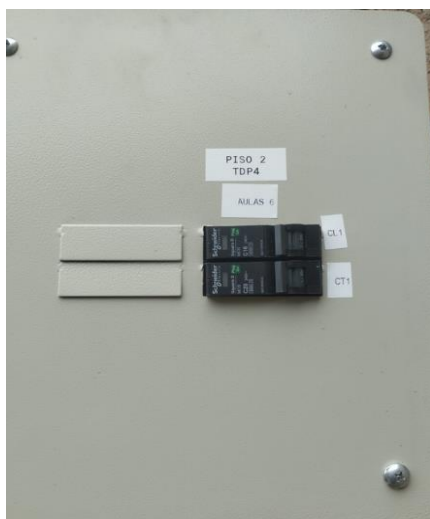
Figura 3.36. Tablero de distribución 1 Fuente: Propia
