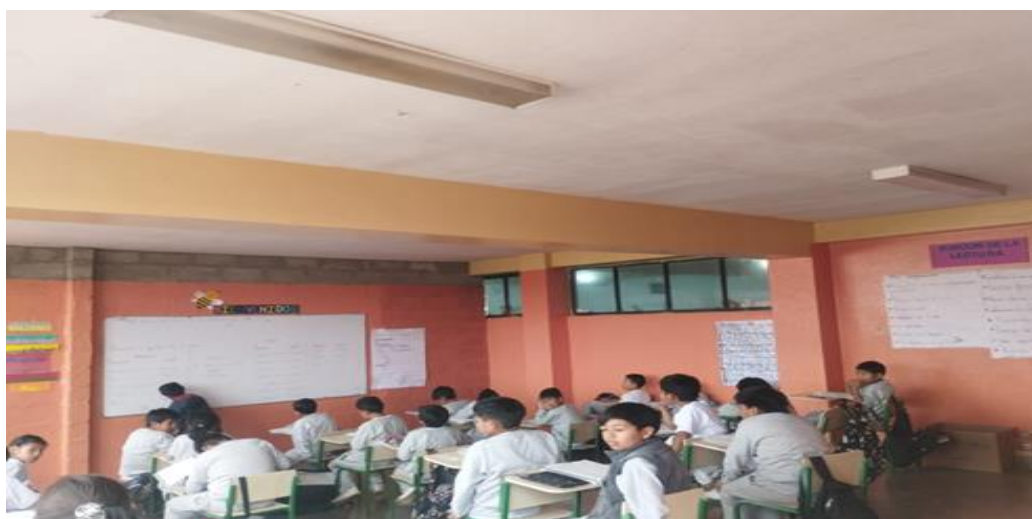
Figura 3.74. Luminarias instaladas aula 6
