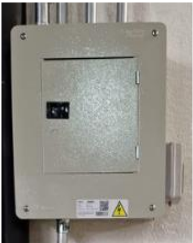
Figura 3.39. Tablero de distribución 4 Fuente: Propia
