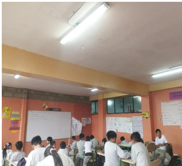
Figura 4.20. luminarias led nuevas encendidas
