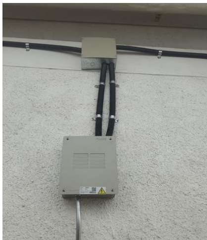
Figura 3.38. Tablero de distribución 3 Fuente: Propia
