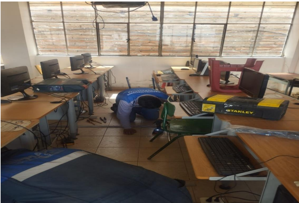
Figura 3.69. Tomas instalados Centro de computo
