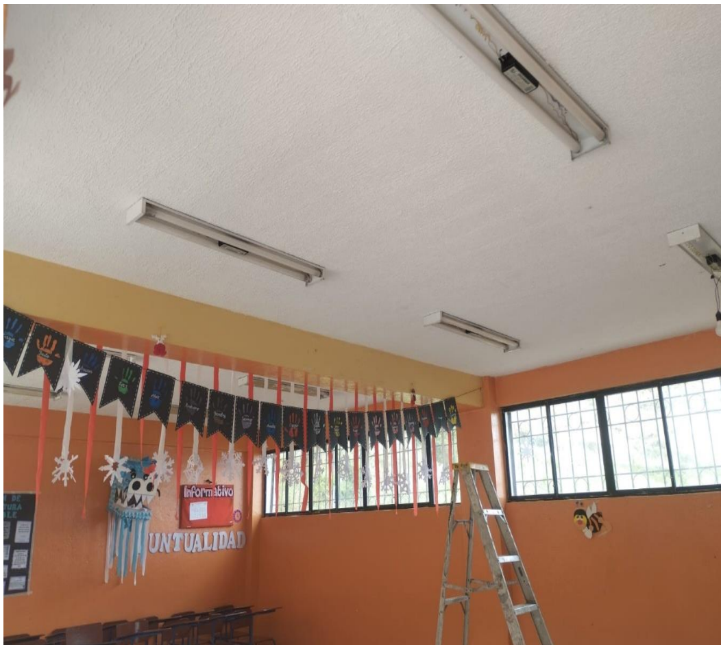
Figura 3.54. Instalaciones anteriores aula 2
