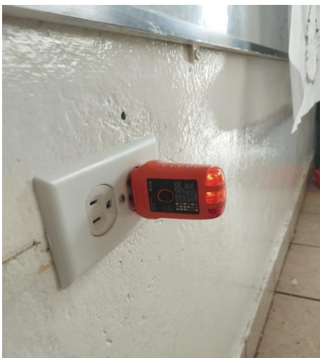
Figura 4.14. punto de fuerza en correcto funcionamiento
