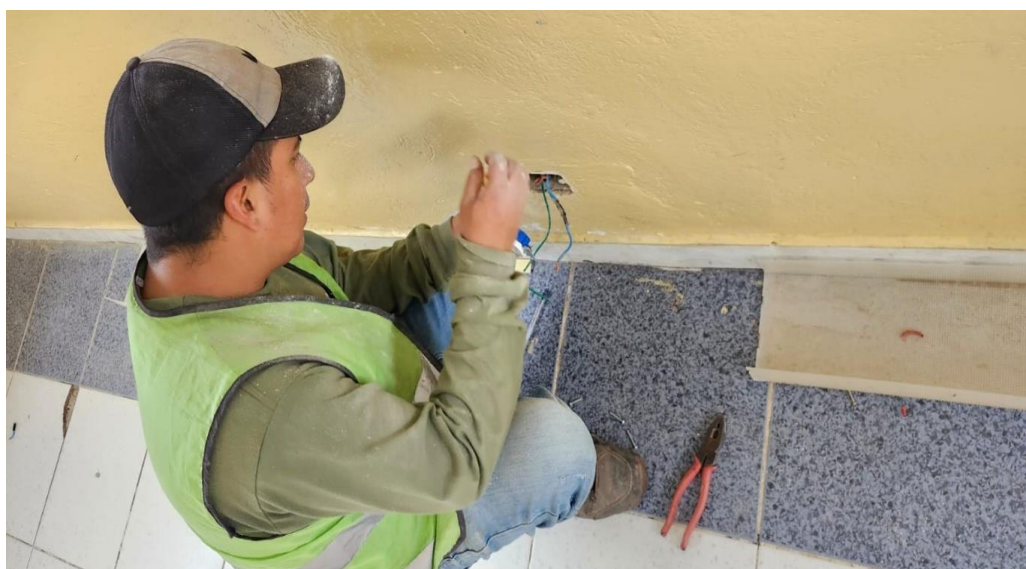
Figura 3.52. Tomacorrientes nuevos instalados aula 1
