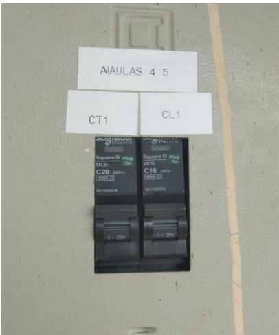
Figura 3.37. Tablero de distribución 2 Fuente: Propia
