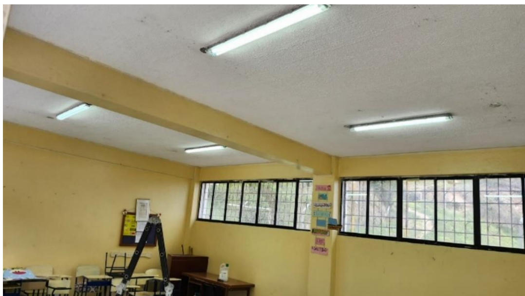
Figura 3.51. Luminarias nuevas instaladas aula 1
