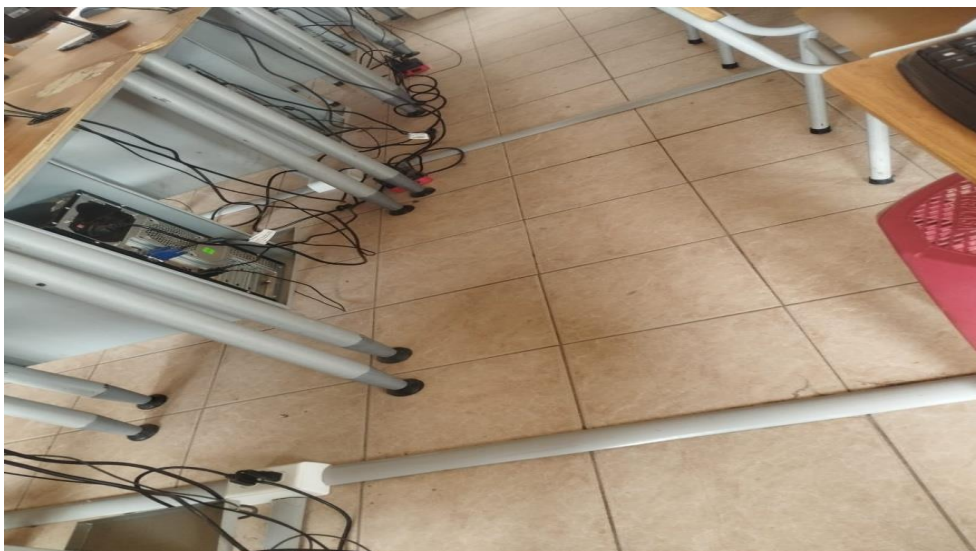
Figura 3.71. Tomas de piso Centro de computo
