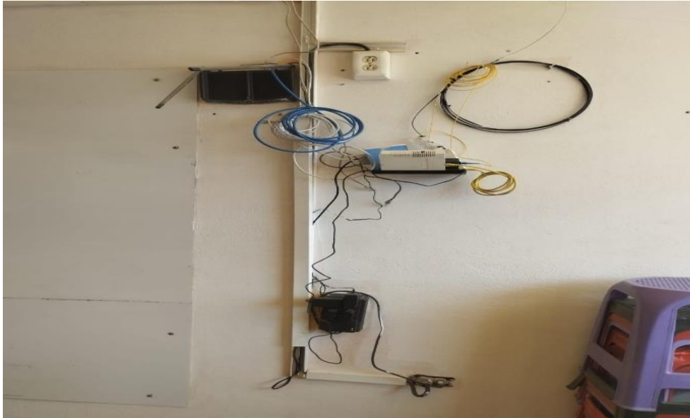
Figura 3.68. Tomas instalados Centro de computo
