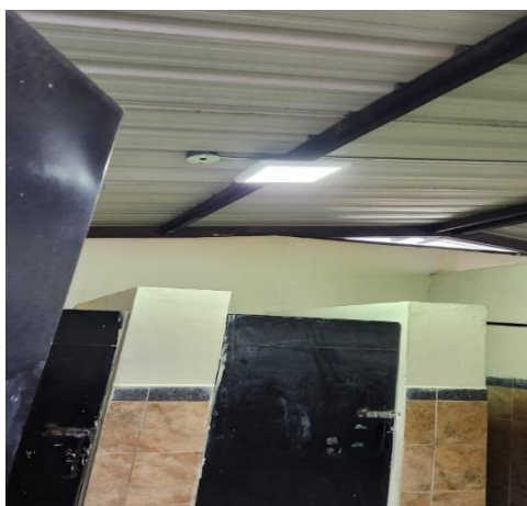
Figura 4.32. luminaria led encendida Fuente: propia
