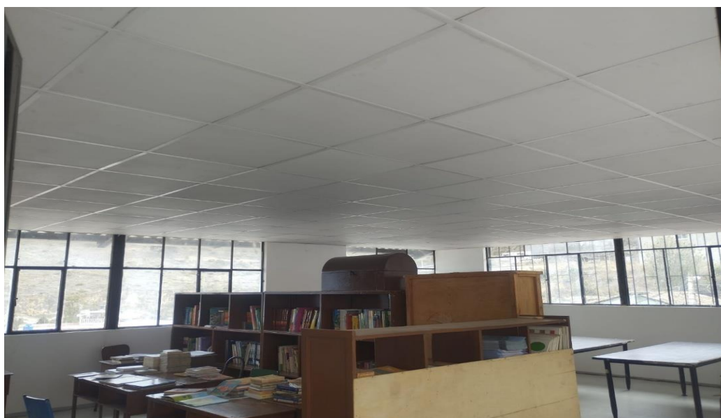
Figura 3.844. aula 8 sin luminarias
