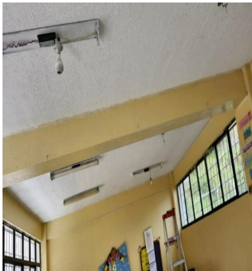
Figura 3.45. Luminarias anteriores aula 1
