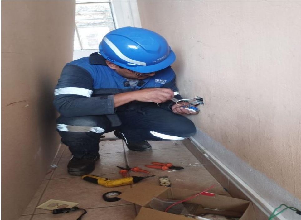
Figura 3.70. Tomas instalados Centro de computo
