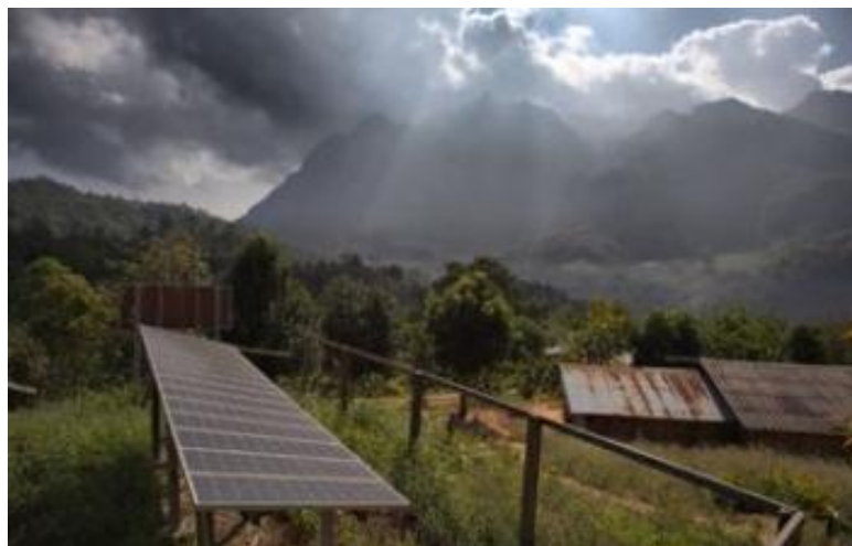
Figura 4 Sistema fotovoltaico tipo isla
