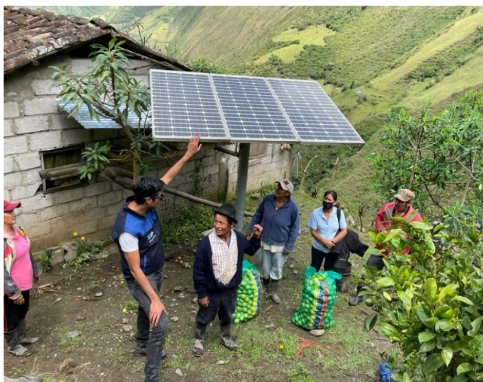
Figura 5 Implementación de microrredes fotovoltaicas en áreas rurales, caso de Cangahual
