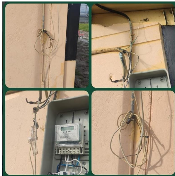
Figura 19 Medidor en mal estado
