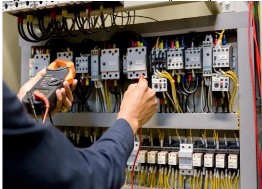
Figura 2 Redes eléctricas de bajo voltaje
