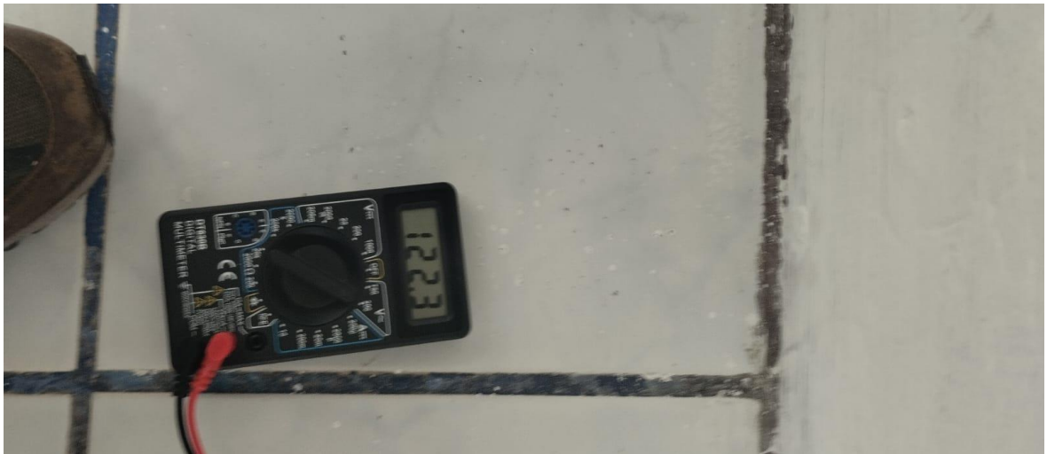
Figura 16.2: Medición de voltaje en un tomacorriente del Aula 2.
