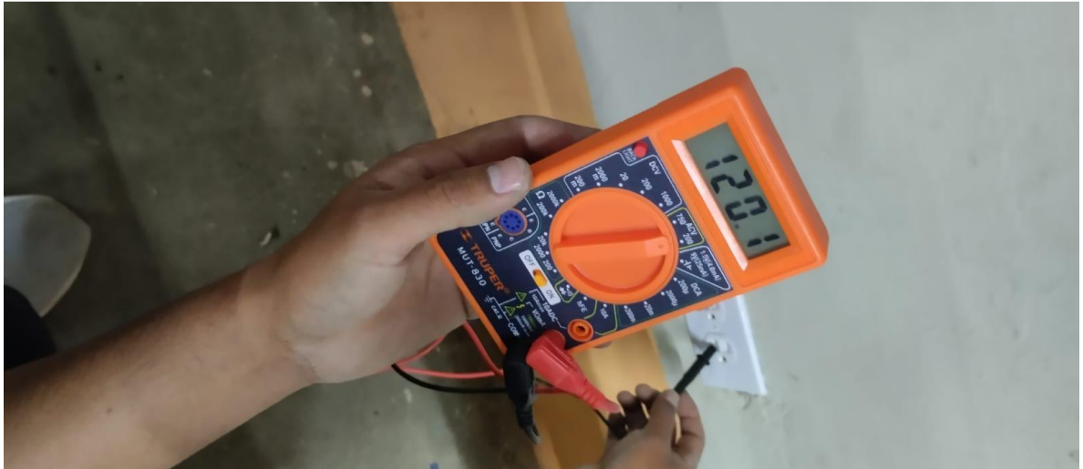
Figura 16.3: Medición de voltaje en un tomacorriente de la sala principal.
