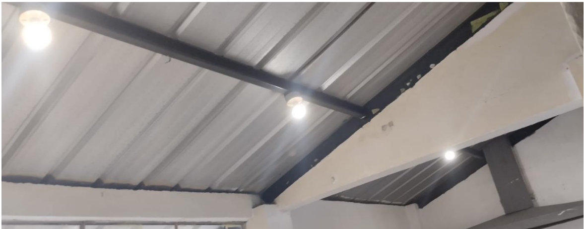
Figura 11.5 Implementación de tres luminarias
