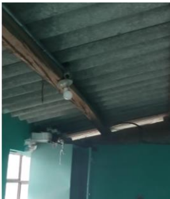
Figura 14.8 Iluminación en un mal estado
