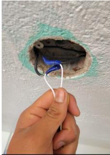
figura 12.7 cables sueltos de parte de la iluminación
