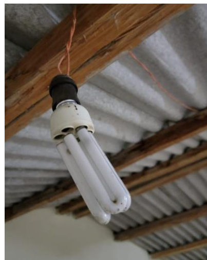
Figura 13.5 iluminación en un mal estado
