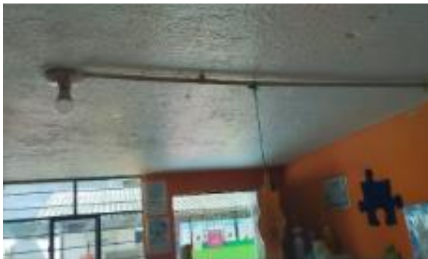
Figura 12.6 La iluminación no es adecuada para una aula1
