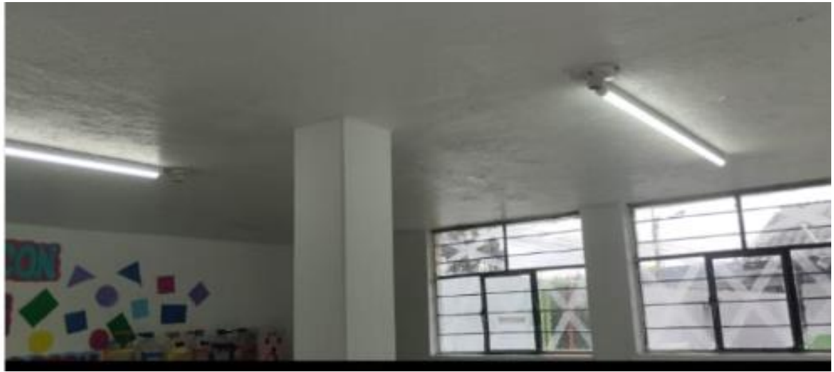
Figura 13.1 Circuito de iluminación implementada
