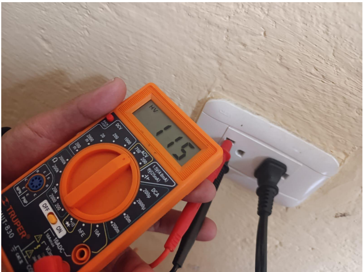
Figura 16.4: Medición de voltaje en un tomacorriente de la cocina.
