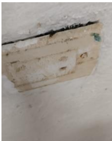
Figura 9.7 Mal estado del toma
