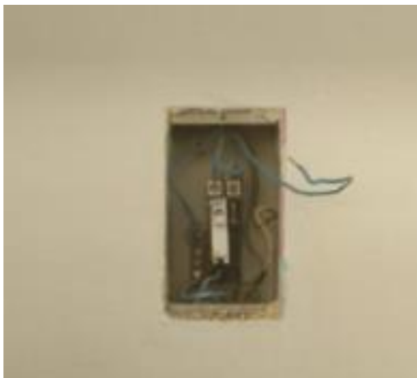
Figura 9.5 La caja termica cables desconectado
