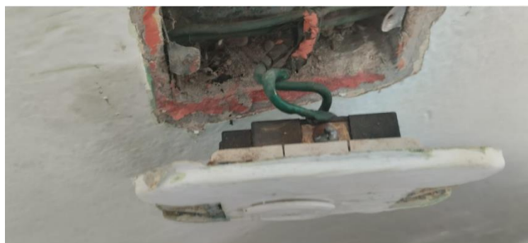
Figura 9.3 Revisión del circuito de fuerza
