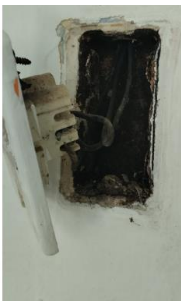
Figura 11.3 interruptor de mal estado
