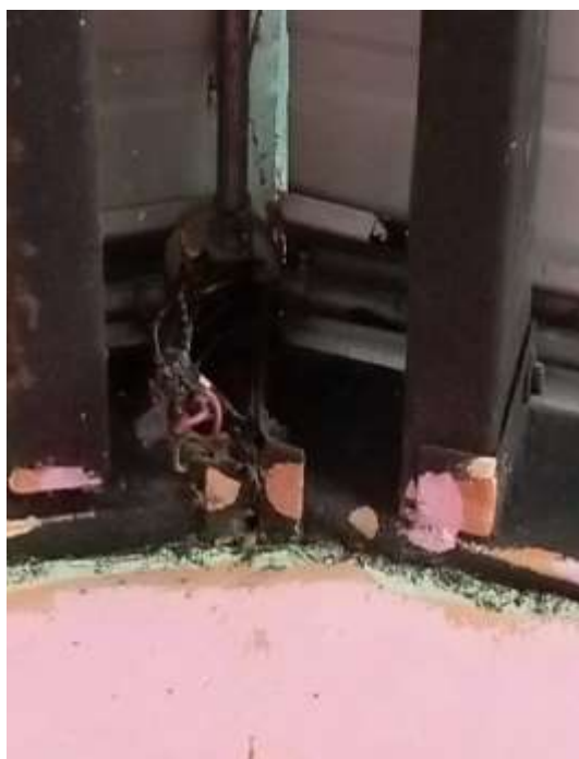
Figura 72 Cajetines en mal estado y cable sulfatado.
