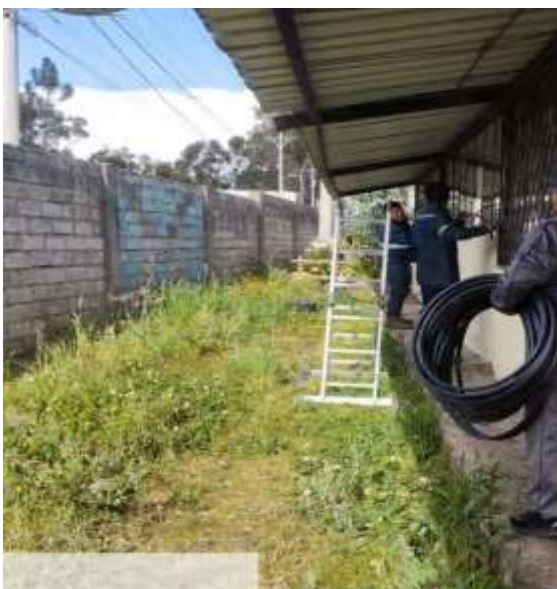
Figura 53 Gestores con cableado de puerto
