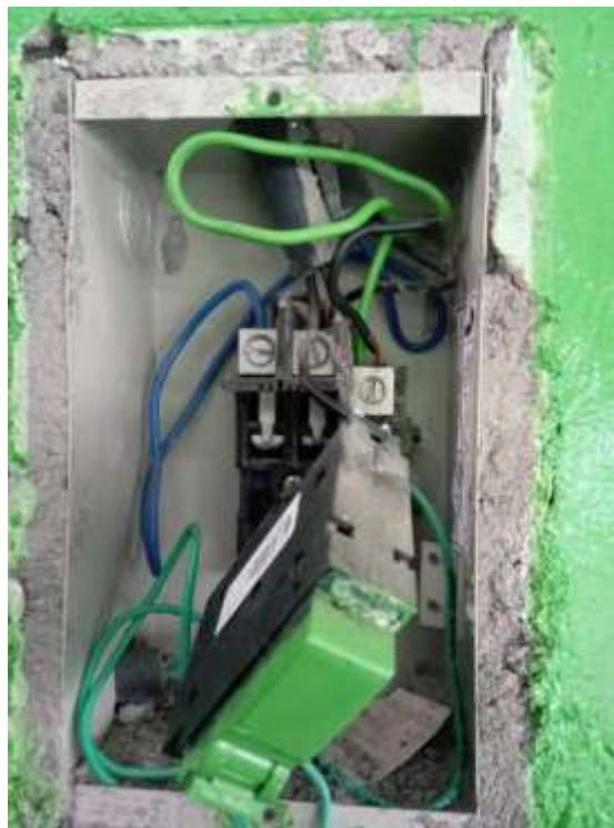
Figura 79 Breakers mal estado
