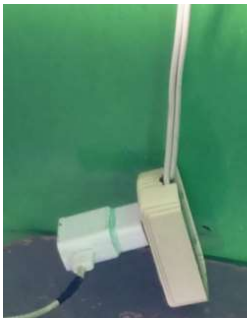
Figura 74 Tomacorriente al intemperie
