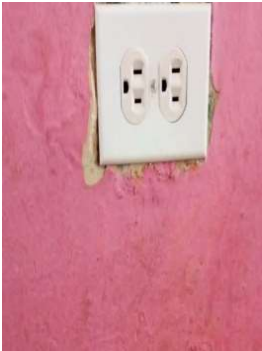
Figura 47 Cambios de tomacorrientes
