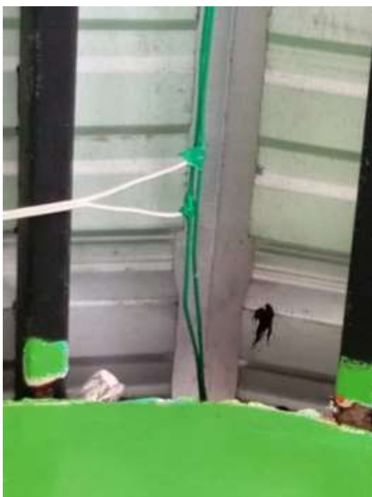
Figura 76 Cables sin tuberías y sin cajetines para los empalmes
