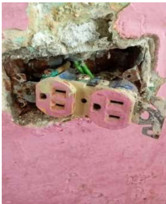
Figura 80 Tomacorrientes y cables sulfatados.
