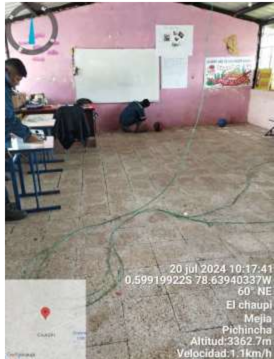
Figura 60 Cableado en el aula
