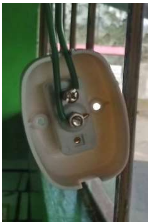
Figura 73 Interruptor en mal estado.
