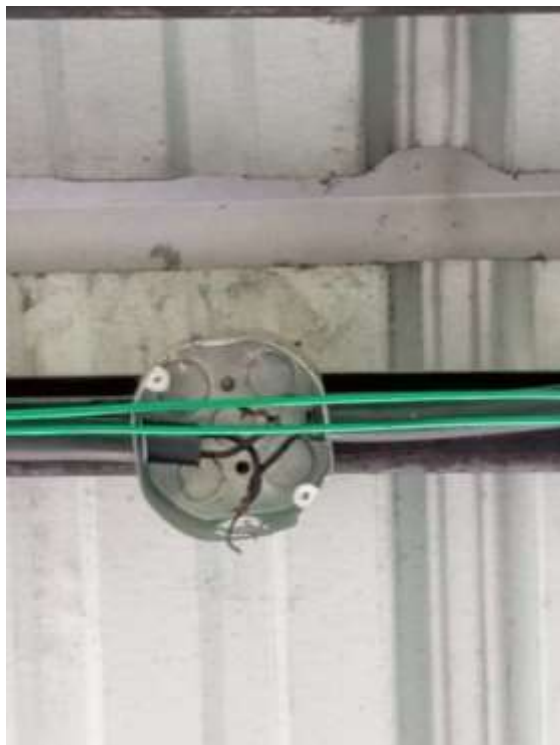
Figura 78 Cajetines y cables sin tapas
