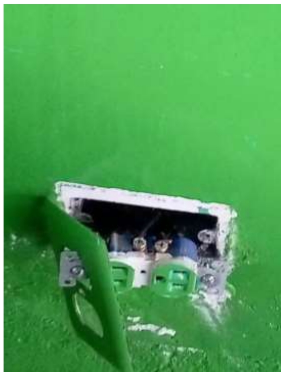
Figura 75 Tomacorriente fuera de uso y sin aislamiento
