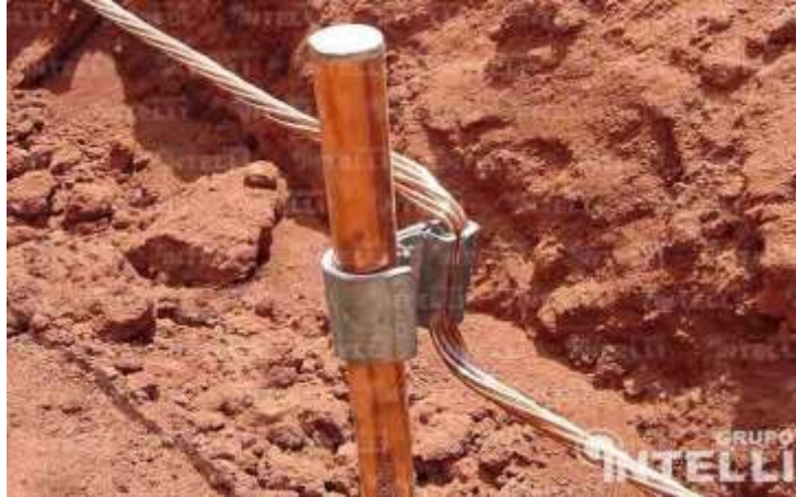
Figura 18 Instalaciones de puesta a tierra Fuente: PadillaSoto, 2023).
