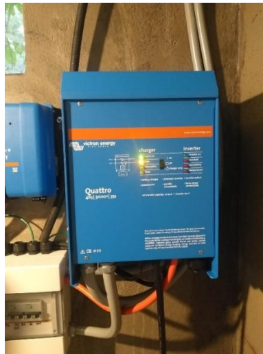
Figura 80: Inversor sincronizado con el generador
