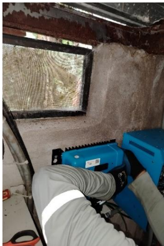
Figura 46: Fijación del controlador MPPT 150/85
