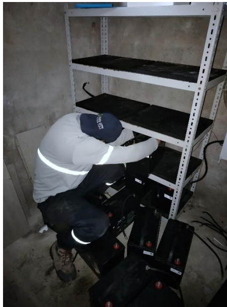
Figura 53: Colocación del primer ramal de baterías
