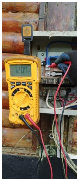
Figura 91: Pruebas de tensión en tablero principal
