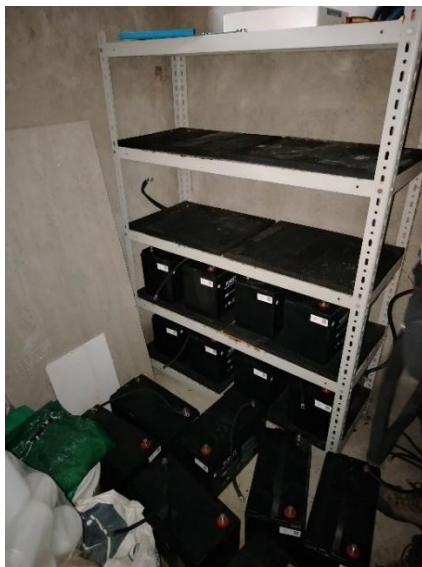
Figura 54: Segundo ramal de baterías en serie
