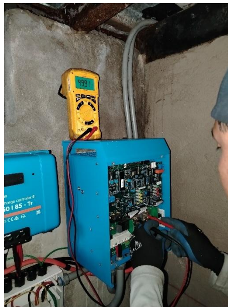
Figura 98: Prueba de tensión en inversor banco de baterías y controlador
