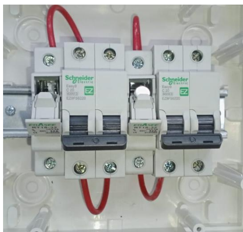
Figura 52: Ejemplo de protecciones interconectadas con porta fusible
