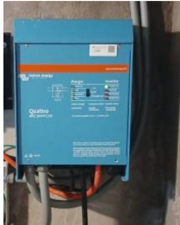
Figura 81: Inversor en estado "invertir on"
