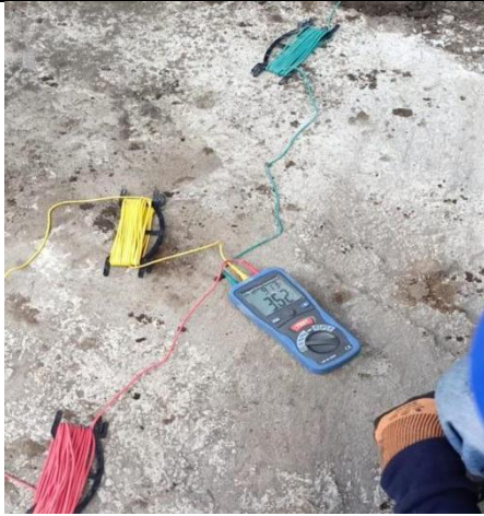
Figura 33 Medicion de la puest a tierra tratada Autor: Propia
