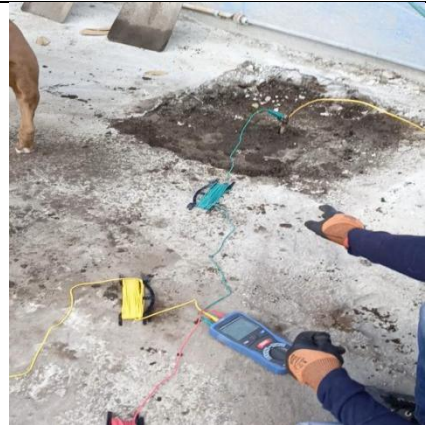
Figura 32 Medidas de la puesta a tierra tratada Autor: Propia
