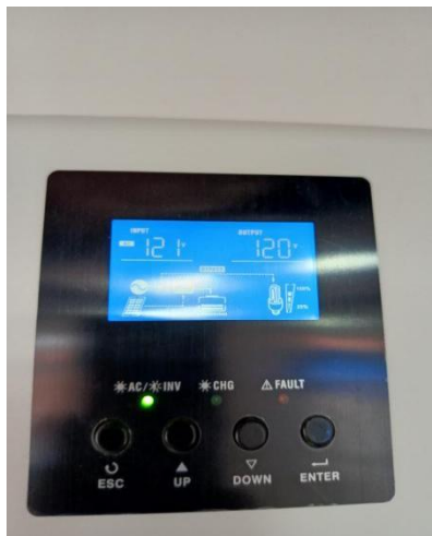
Figura 56 Carga de baterias con la red Autor: Propia
