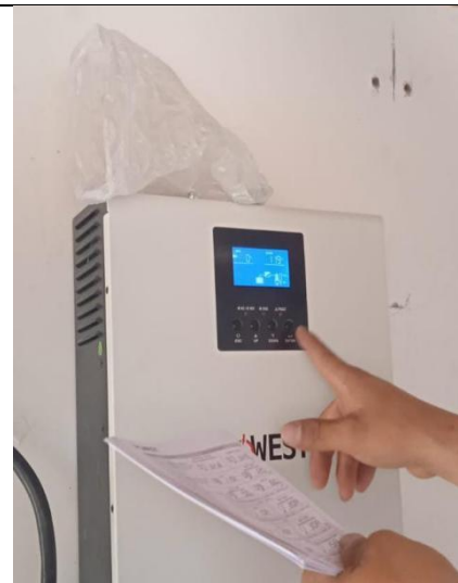
Figura 55.1 Programacion del inversor Autor: Propia
