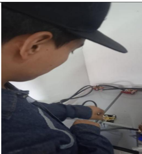
Figura 47 Coneccion de las 2 baterias Autor: Propia
