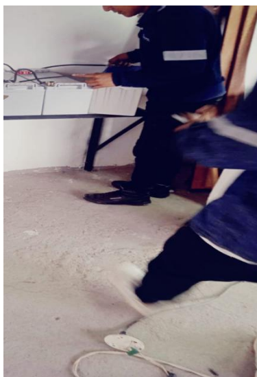
Figur 48 Colocacion de las 2 baterias Autor: Propia
