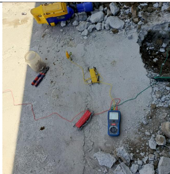
Figura 25 Picas de la puesta a tierra Autor: Propia
