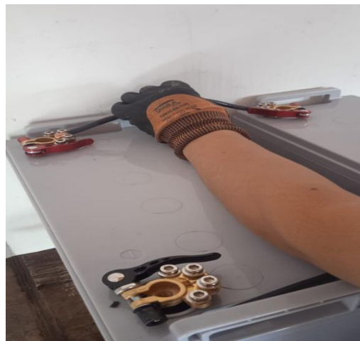
Figura 47.1 Coneccion de las 2 baterias Autor: Propia
