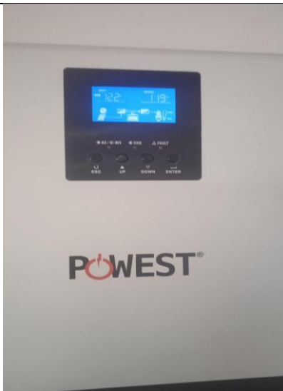
Figura 55 Programacion del inversor Autor: Propia
