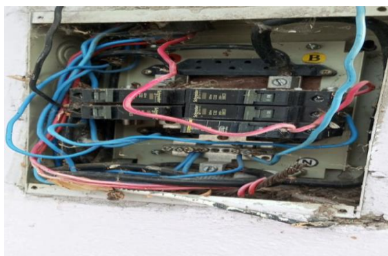
Figura 17: Centro de carga de la instalación.
