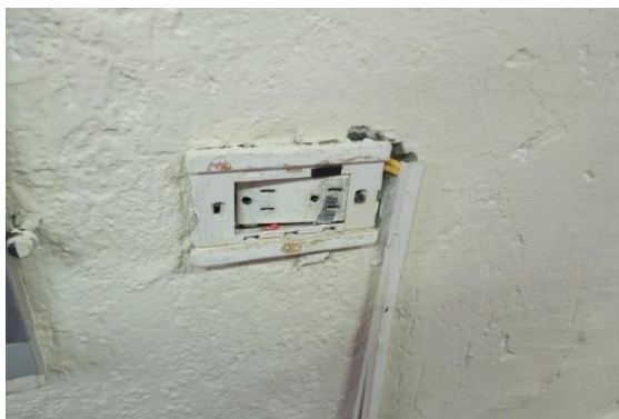
Figura 16: Tomacorrientes en mal estado.
