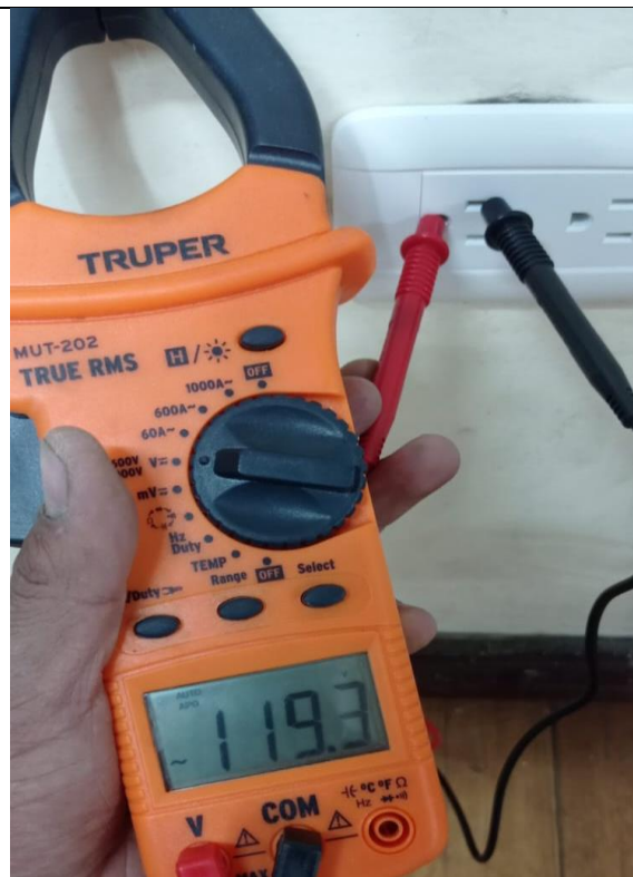
fase y tierra Después Voltios (V)
