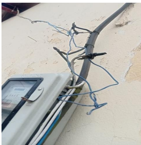
Fig. 21 acometida al tablero de distribución
