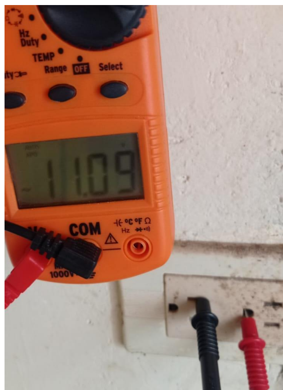
fase y tierra Antes Voltios (V)
