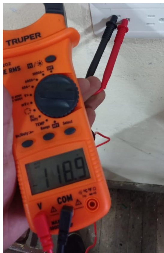
fase y tierra Después Voltios (V)
