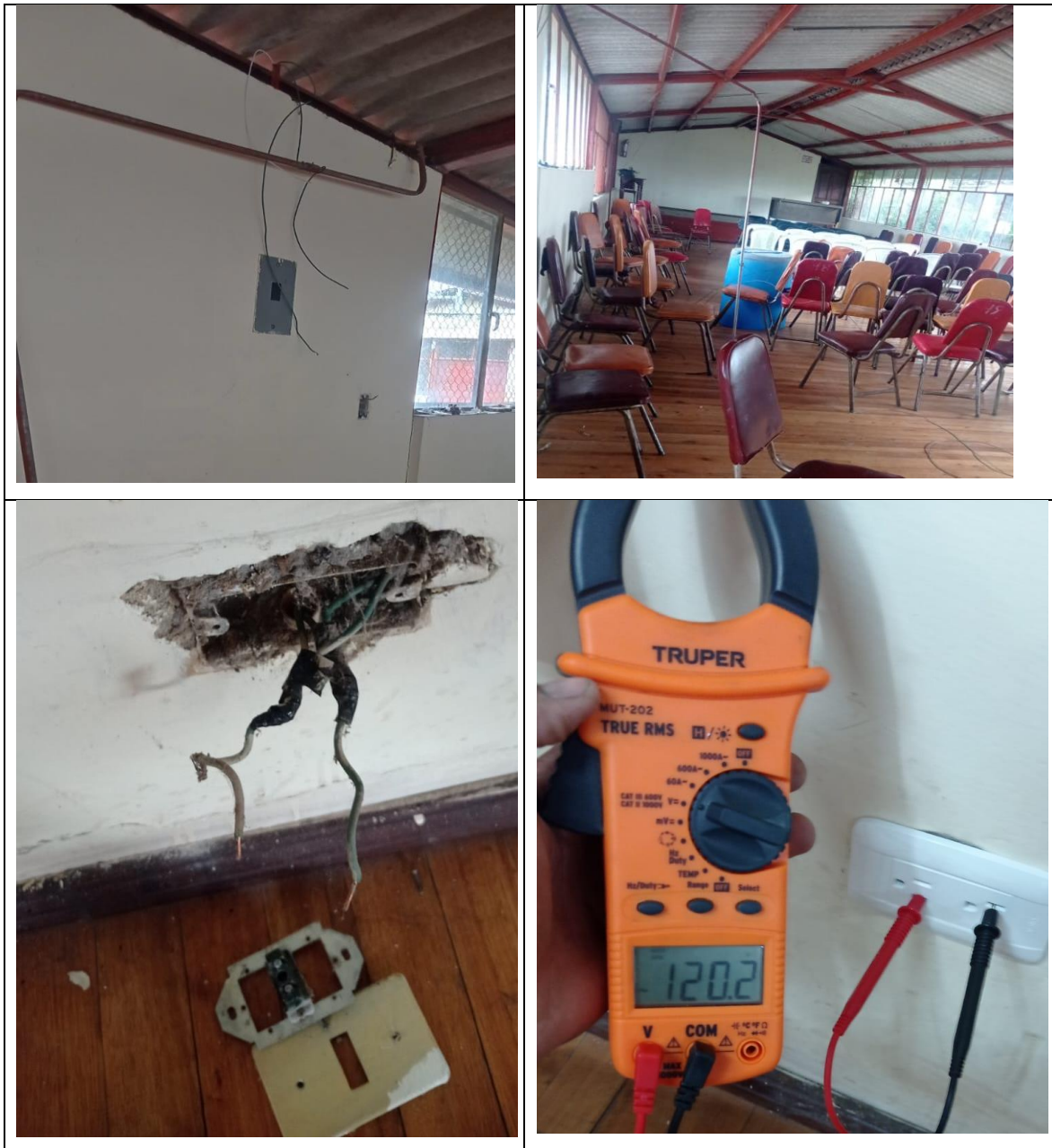
Fig. 49 implementación de circuito de fuerza
