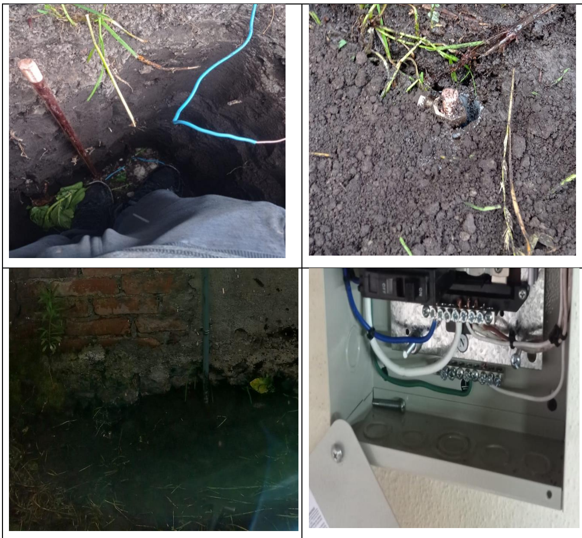
Fig. 3.30 implementación de circuito de puesta a tierra
