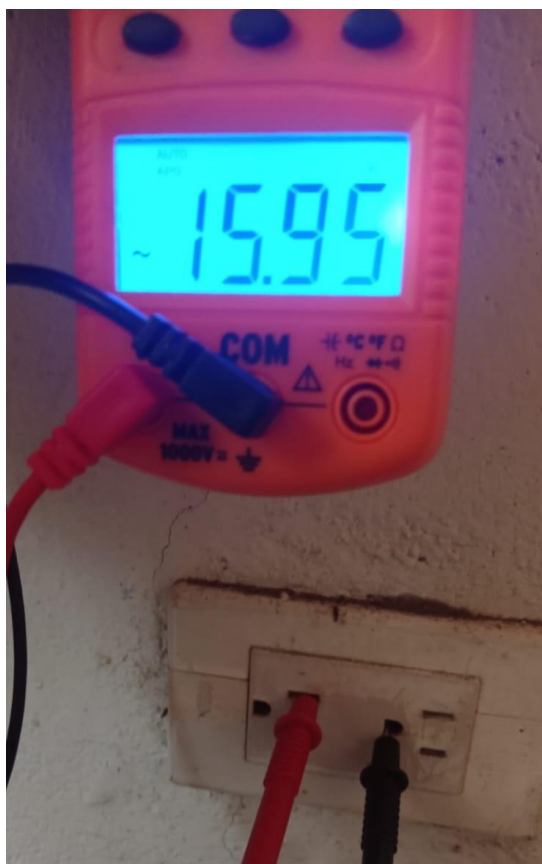
fase y tierra Antes Voltios (V)
