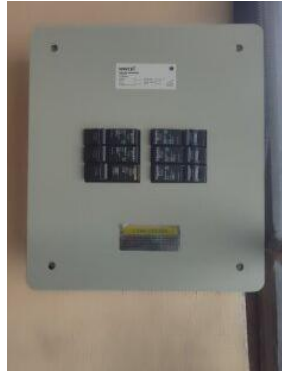
Figura 25. Centro de carga
