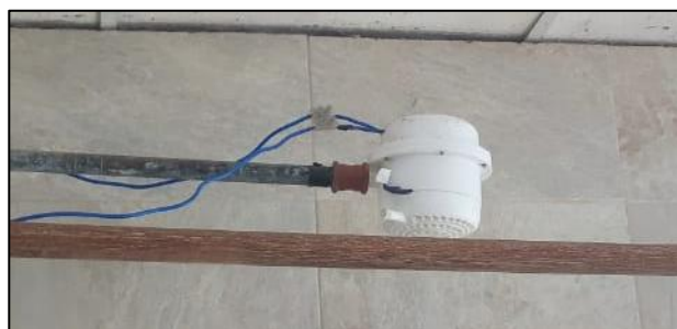
Figura 10. Conexión de la ducha en mal estado
