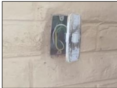
Figura 9. Interruptor en mal estado de la jefatura
