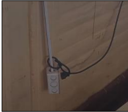
Figura 8. Tomacorriente en mal estado, dormitorio
