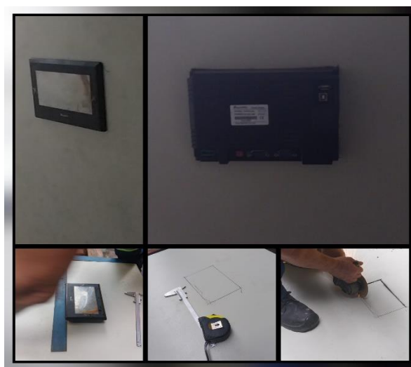
Figura 30 Instalación Física de la pantalla Fuente. (Autor)
