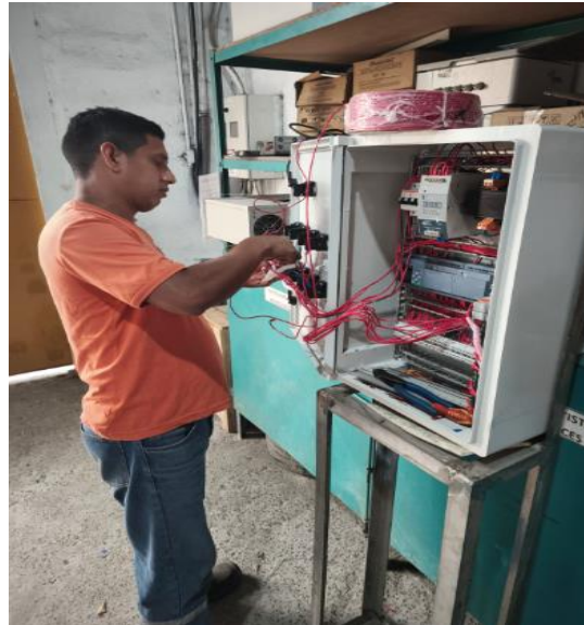
Figura 27: Cableado del tablero
