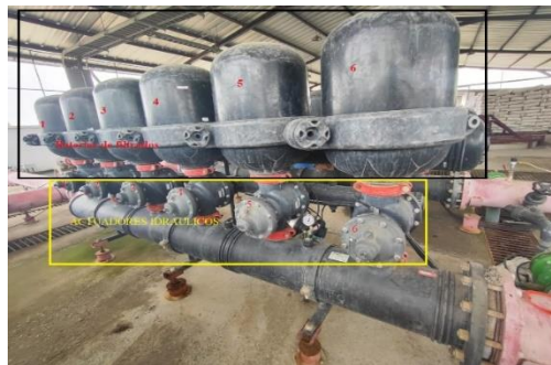
Figura 11: Baterías de filtrado
