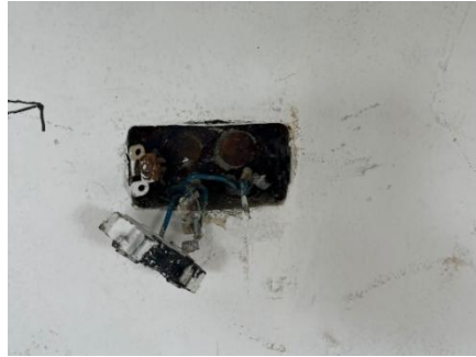
Figura 20. Interruptor en mal estado Fuente: Autoría propia
