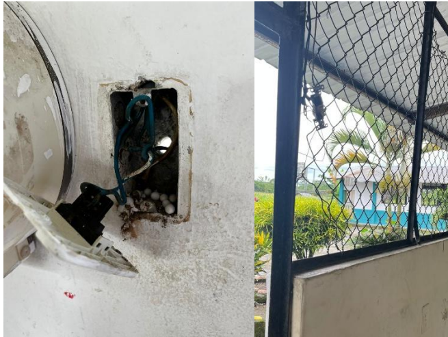
Figura 51. Interruptores iniciales. Fuente: Fotografía propia.
