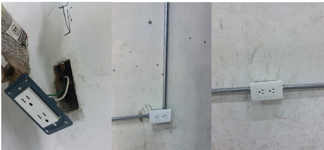
Figura 49. Tomacorrientes Actual Fuente: Fotografía propia.
