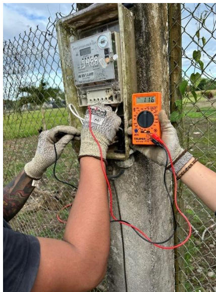
Figura 68. Medición en el medidor eléctrico Fuente: Fotografía propia.
