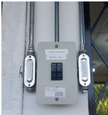
Figura 44. Tablero principal actual. Fuente: Fotografías propia
