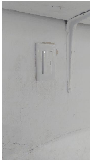
Figura 50. Interruptores actuales. Fuente: Fotografía propia.
