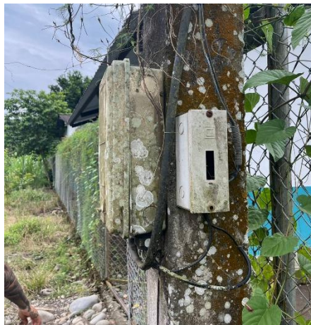
Figura 45. Tablero principal inicial. Fuente: Fotografías propia
