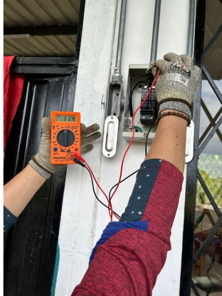
Figura 69. Medición en el tablero principal Fuente: Fotografía propia.
