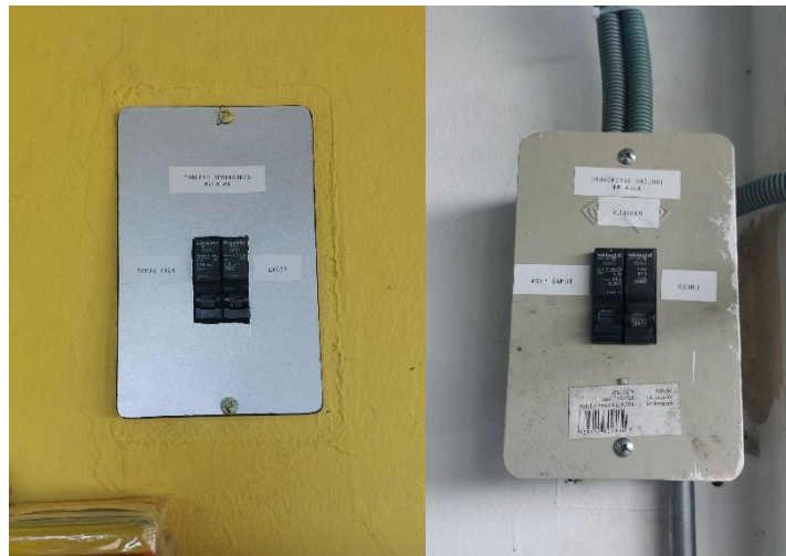
Figura 47. Tablero secundario del aula #1 y Aula #4, actual Fuente: Fotografía propia.
