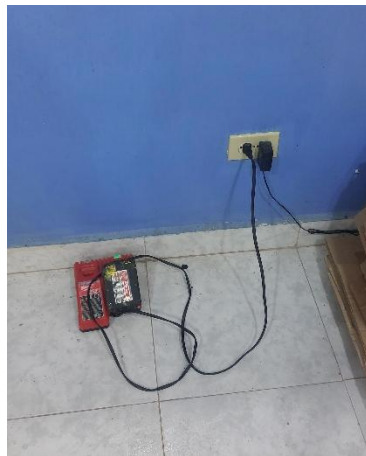
Figura 60. Tomacorriente del aula #3 Fuente: Fotografía propia.
