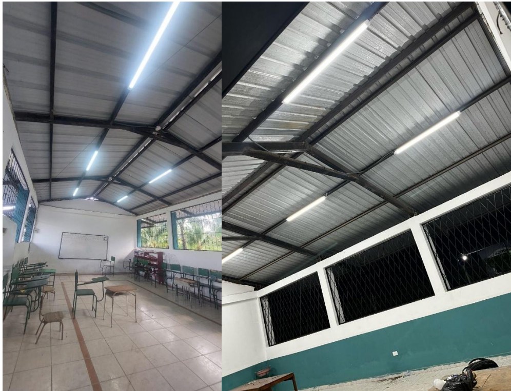
Figura 58. Luminaria del aula #1 y #2. Fuente: Fotografía propia.
