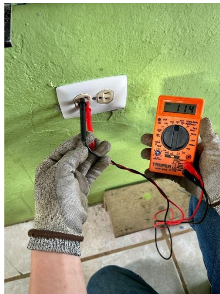
Figura 70. Medición de tomacorriente del aula #1 Fuente: Fotografía propia.
