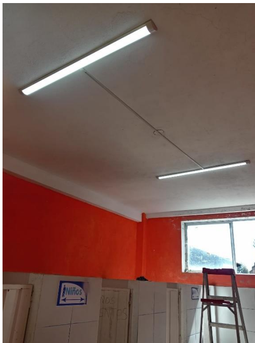
Figura 89. Funcionamiento de la luminaria del baño Figura: Fotografía propia.
