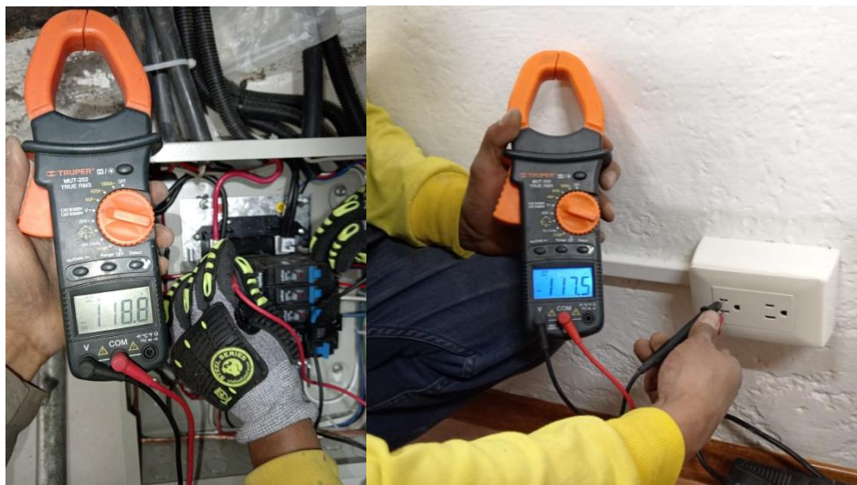
Figura 95. Medición del Cir. Tomacorriente-L. Figura: Fotografía propia.
