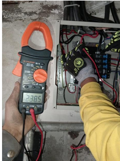
Figura 94. Medición de la acometida Figura: Fotografía propia.
