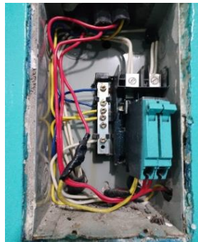
figura 33. Estado inicial del tablero ubicado en el 7mo básica
