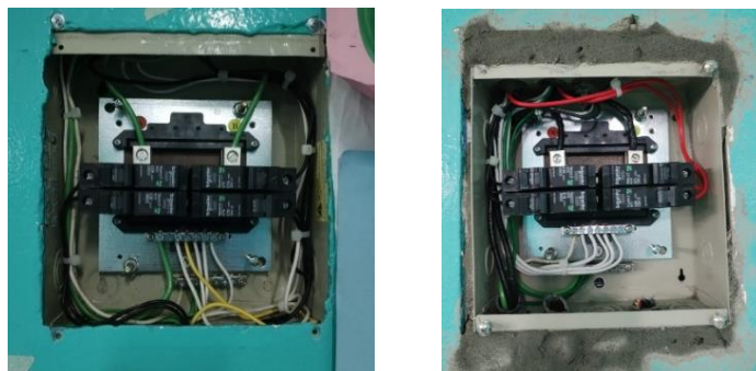
figura 35. Estado actual de los tableros ubicados en el 2do y 7mo básica
