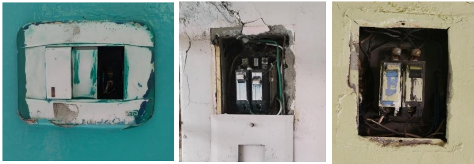
figura 11. Estado actual del sistema electrico
