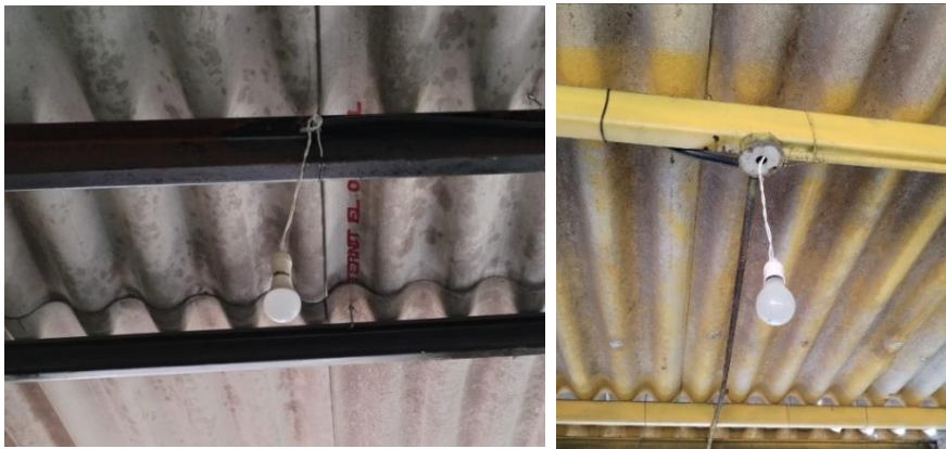
figura 12. Luminarias en mal estado
