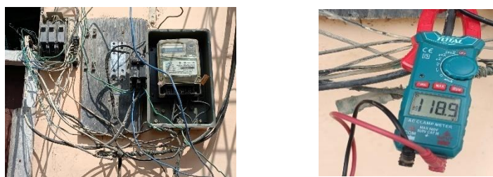
Figura 47. Breakes sobrepuestos directo al medidor
