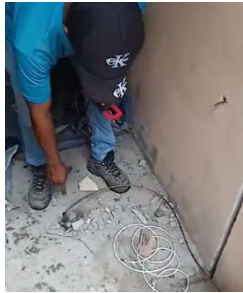
Figura 51. Puesta a tierra estado inicial
