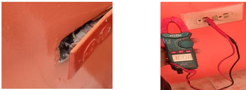
Figura 44. Toma corrientes en mal estado
