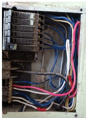
Figura 12. Subtablero de las 4 aulas
