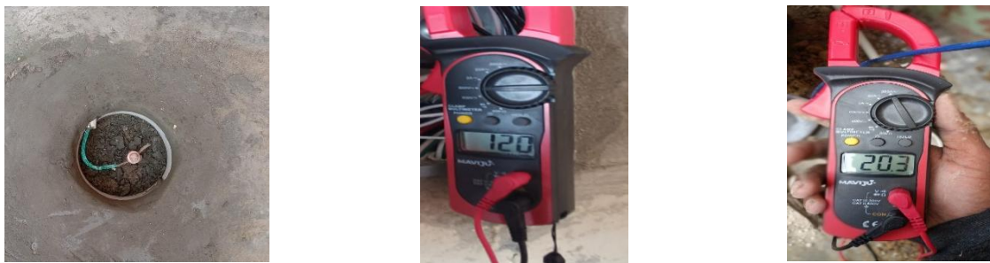
Figura 65. Puesta a tierra TS2, TS4.
