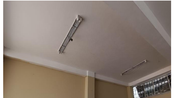
Figura 13. Aulas 1 sin de iluminación.
