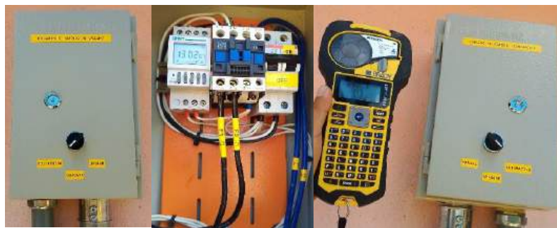
Figura 51. Etiquetado de tablero de control.
