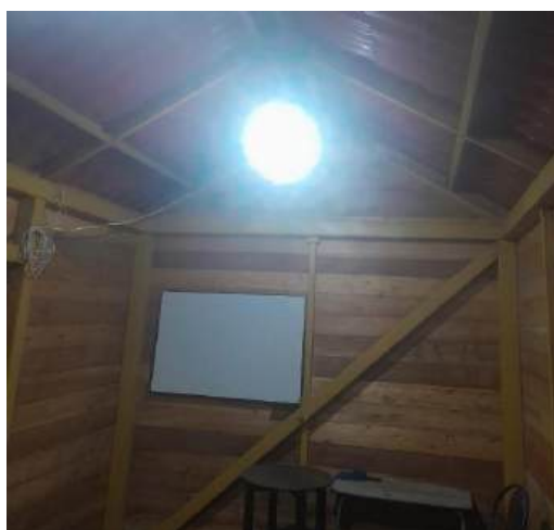
Figura 9. Instalaciones no cumplen con normativas NEC
