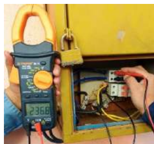
Figura 55. Medida de voltaje en tablero de medición.
