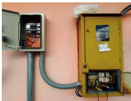
Figura 42. Tablero de medición y tablero de control proyectado.
