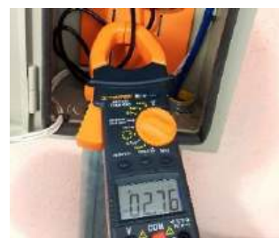
Figura 56. Medida de intensidad en tablero de control.
