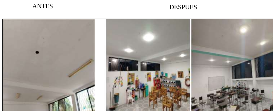
Figura 41. Comparación sistema de iluminación empotrado.
