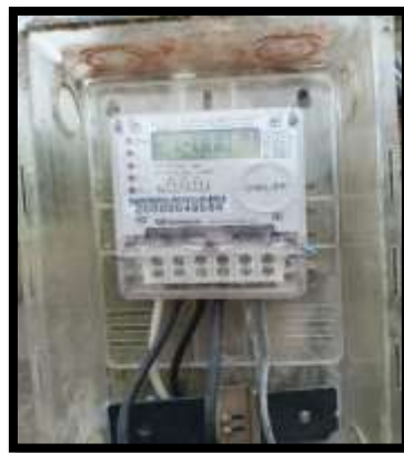
Figura 21. Contador eléctrico Unidad Educativa "Lago San Pedro"
