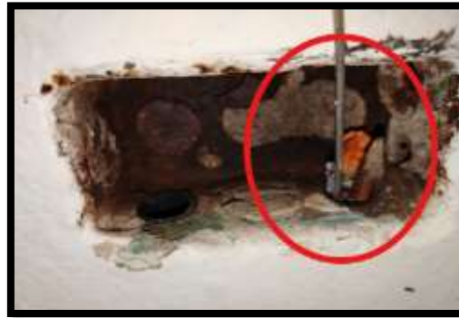
Figura 29. Obstrucción de las canalizaciones
