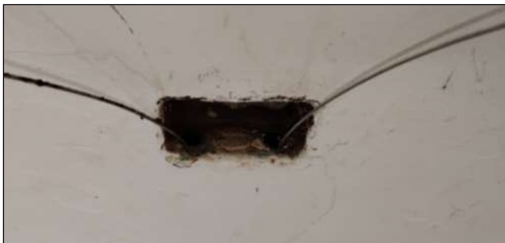
Figura 37. Estado de cajetines eléctricos
