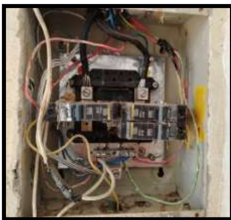
Figura 23. Tablero de distribución TD1
