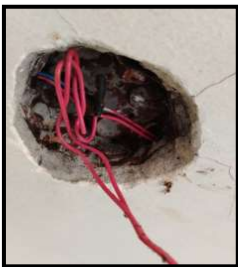
Figura 24. Empalme en mal estado
