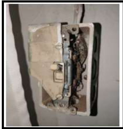
Figura 27. Interruptor en mal estado
