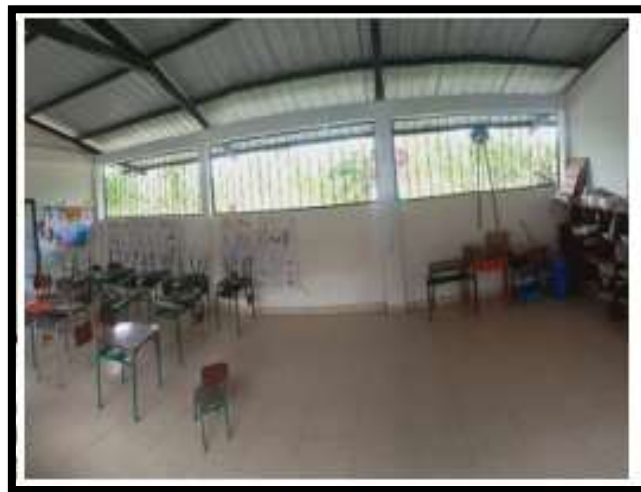
Figura 28. Ausencia de luminarias en las aulas
