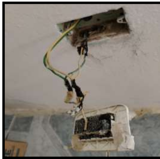
Figura 26. Tomacorrientes en mal estado
