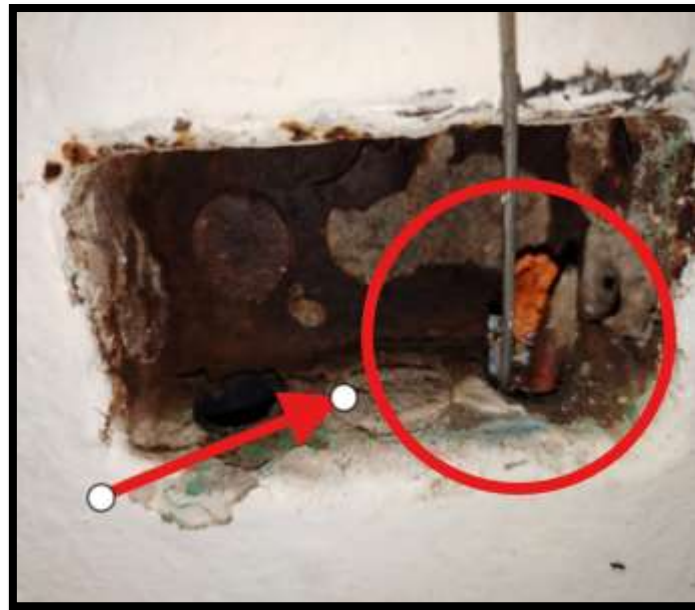
Figura 44. Obstrucción en canalizaciones empotradas
