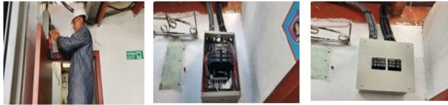
Figura 36. Tablero distribución principal
