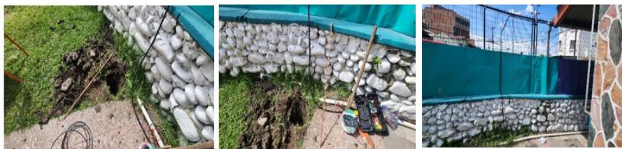
Figura 55. Conexión a tierra
