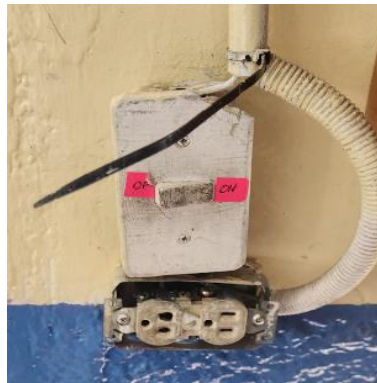
Figura 20. Tomacorrientes e interruptores en mal estado
