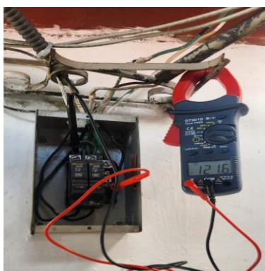
Figura 23. Voltaje del tablero principal
