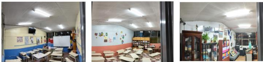
Figura 40. Iluminación interna de aulas
