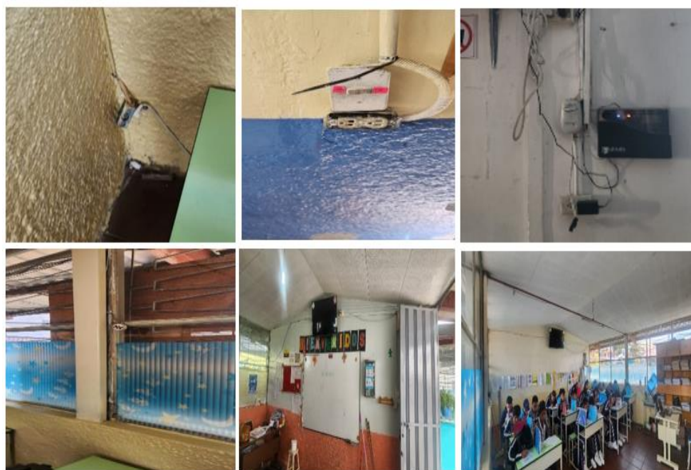
Figura 51. Tomacorrientes del circuito de fuerza inicial
