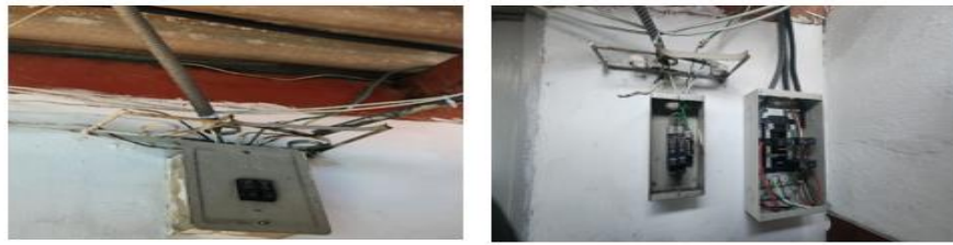
Figura 43. Tablero de distribución principal inicial
