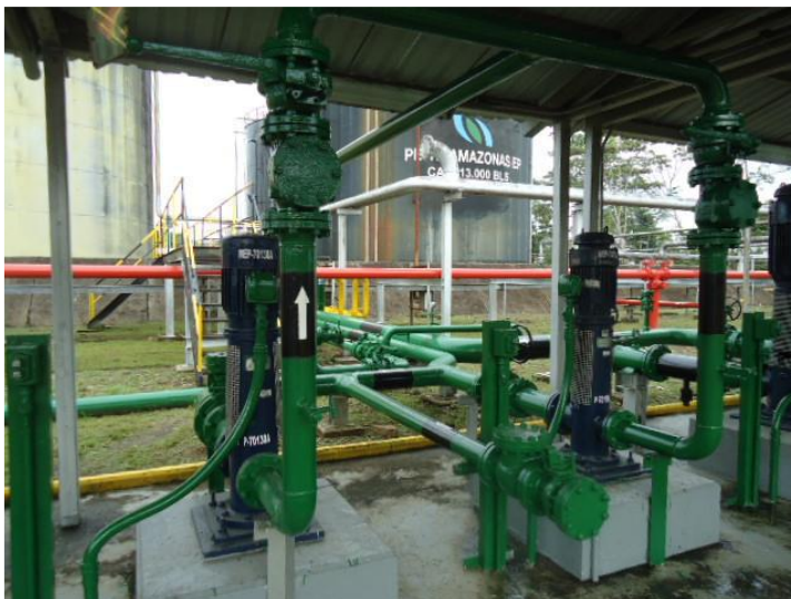
Figura 9. Bombas de Transferencia
