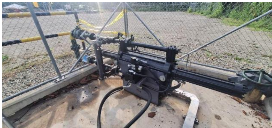
Figura 10. Compresor de gas HVR-100
