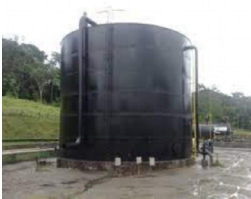
Figura 8: tanque de lavado.
