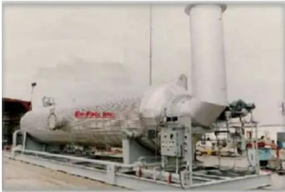
Figura 5: tratador térmico horizontal.
