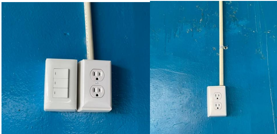
Figura 46 Tomacorrientes implementados en el circuito 2 del área recreacional
