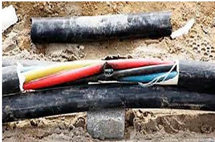
Figura 5 Fallas de aislamiento por cortes y daños mecánicos
