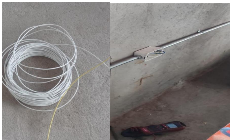
Figura 31 Cableado de toma corrientes
