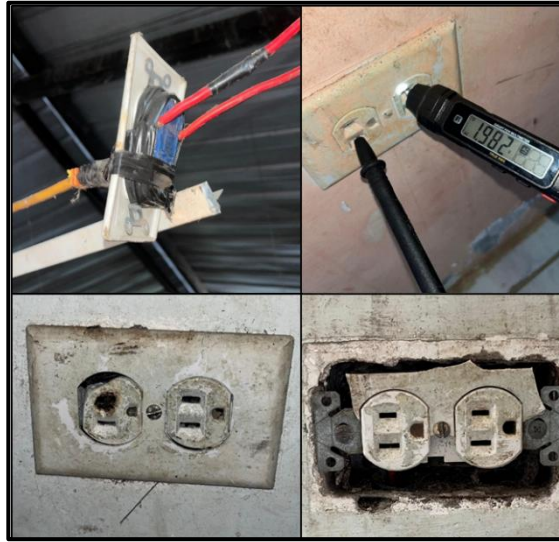
Figura 29: Estado de los Toma Corrientes
