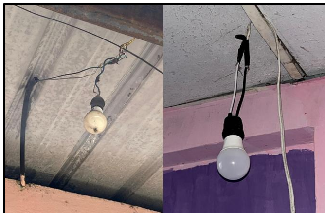
Figura 27: Estado de las Boquillas y Focos Led
