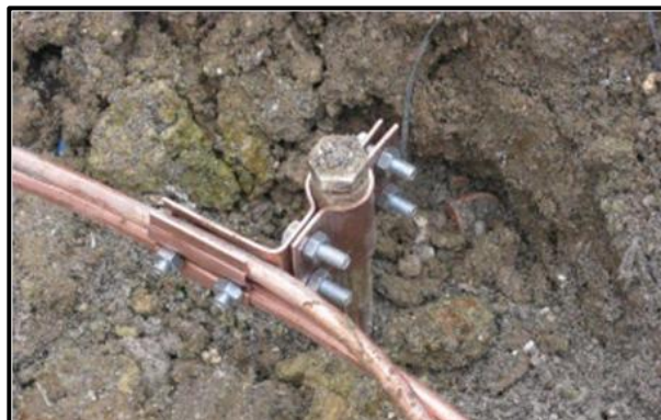
Figura 21: Varilla de Puesta a Tierra.
