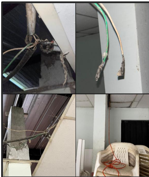
Figura 30: Condición Actual de los Conductores
