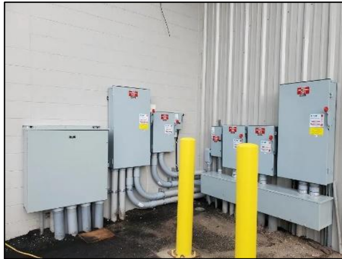
Figura 3: Tableros de Control de una Instalación Comercial
