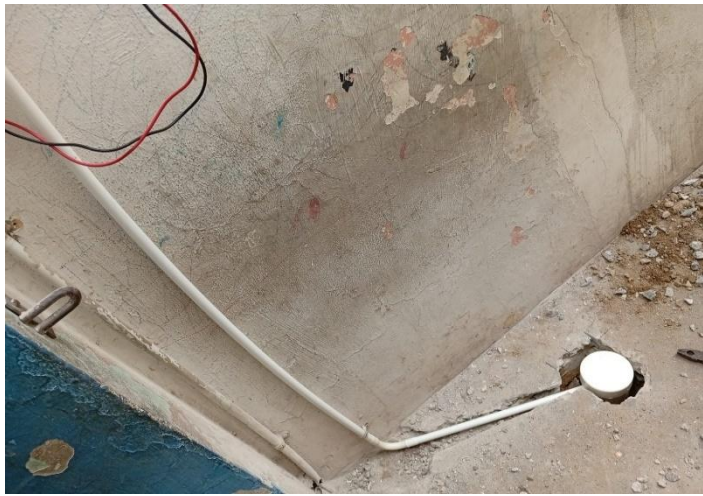
Figura 88 Protección de puesta a tierra
