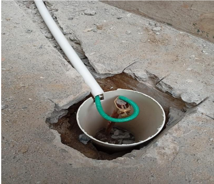
Figura 77 Puesta a tierra implementada
