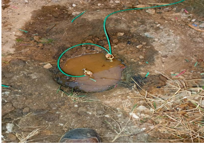
Figura 110 Puesta a tierra implementada al tablero del salón de computo
