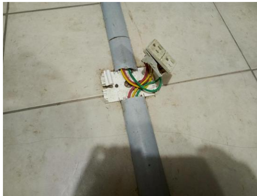
Figura 30 Tomacorrientes en mal estado en el salón de computo
