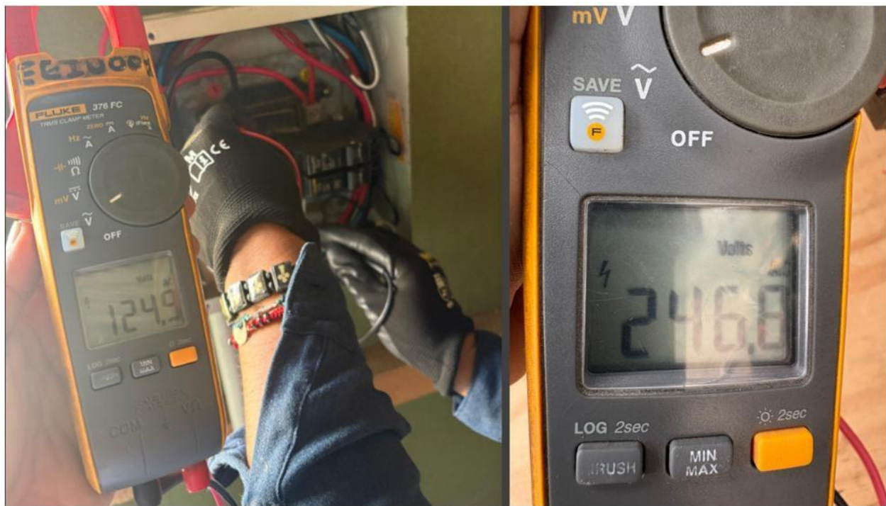
Figura 33. Medición de Voltaje en PD-CNH
