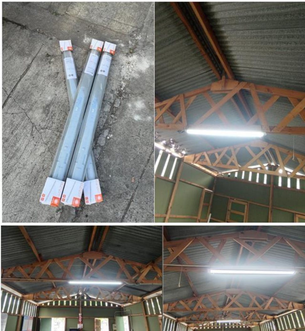
Figura 31. Iluminación en CNH
