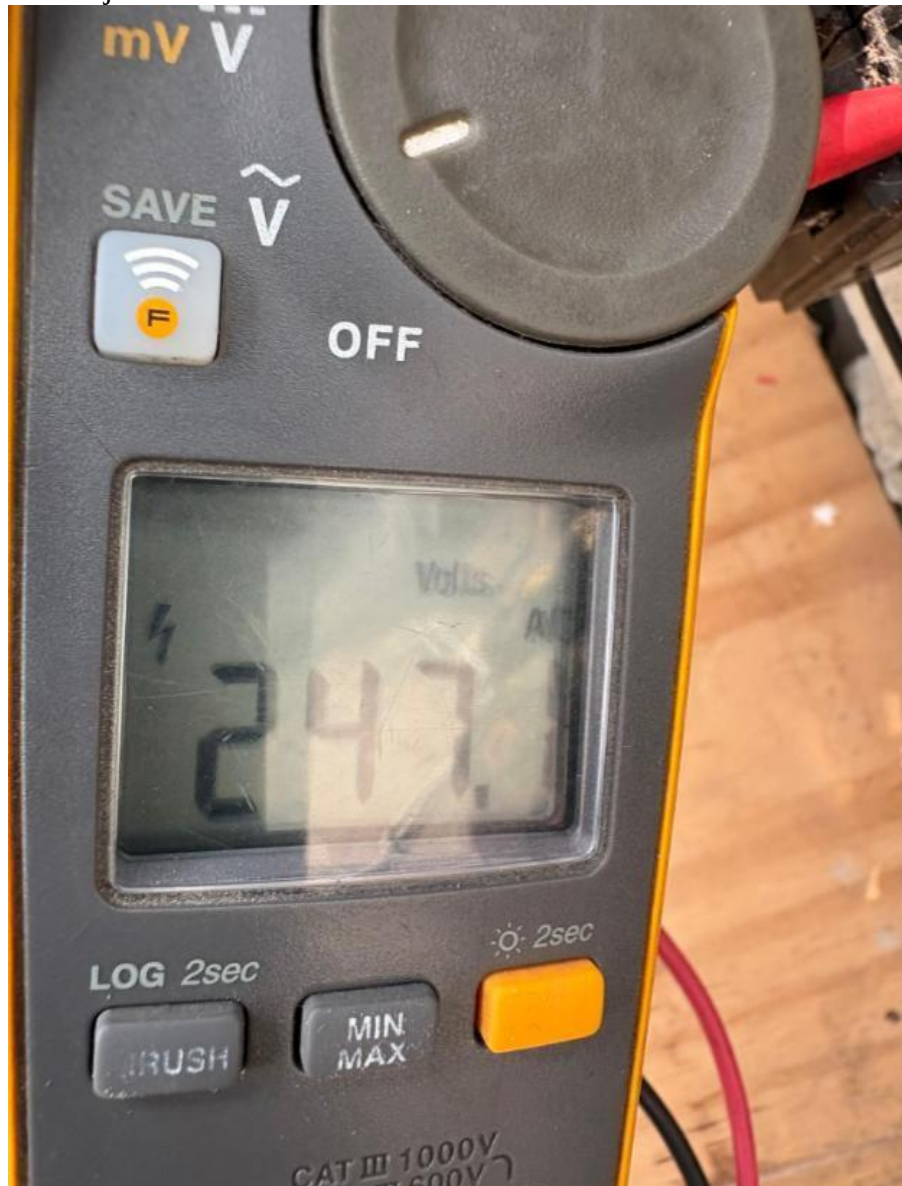
Figura 29. Mediciones de Voltaje en Panel de distribución.
