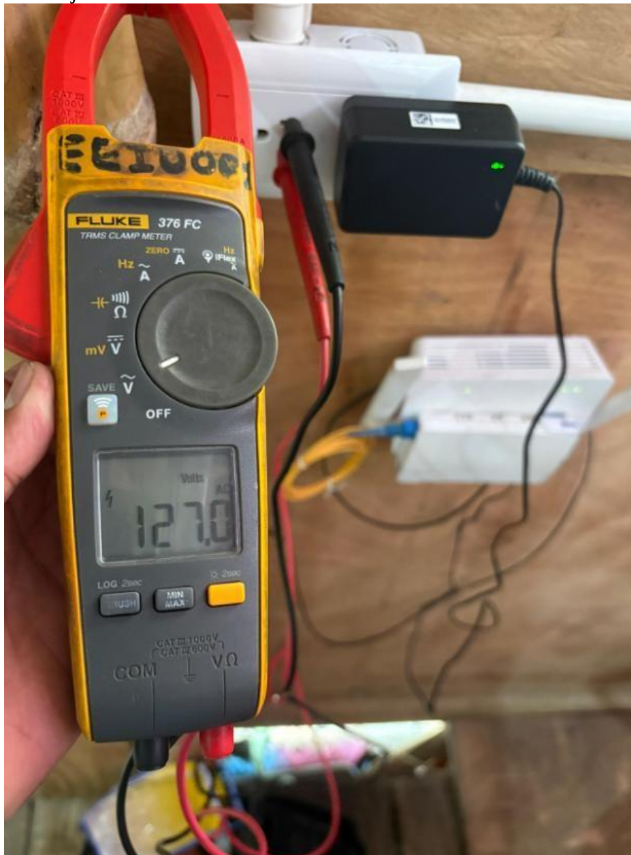
Figura 28. Mediciones de Voltaje en tomacorrientes
