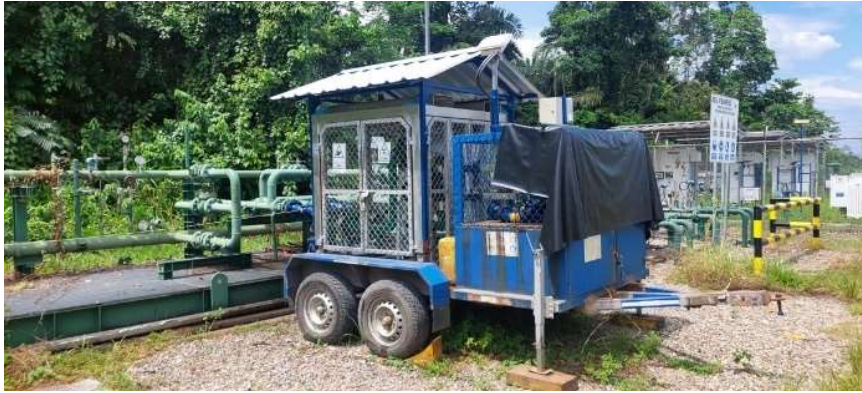
Figura 10: Conexión del medidor multifásico en línea de prueba 4”.
