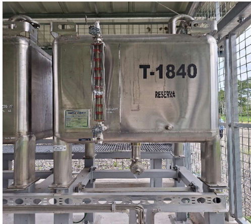
Figura 26: Tanque de almacenamiento de diésel – Bull tank.
