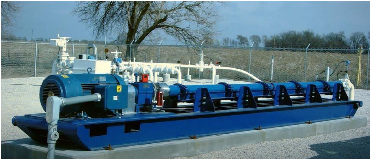
Fig.19.- Bombas horizontales para la inyección de vapor al reservorio.
