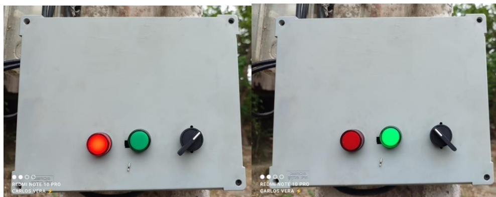
Figura 40 Funcionamiento del tablero eléctrico.
