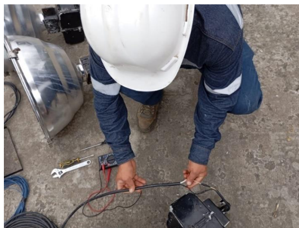
Figura 35 Instalación eléctrica de los reflectores.
