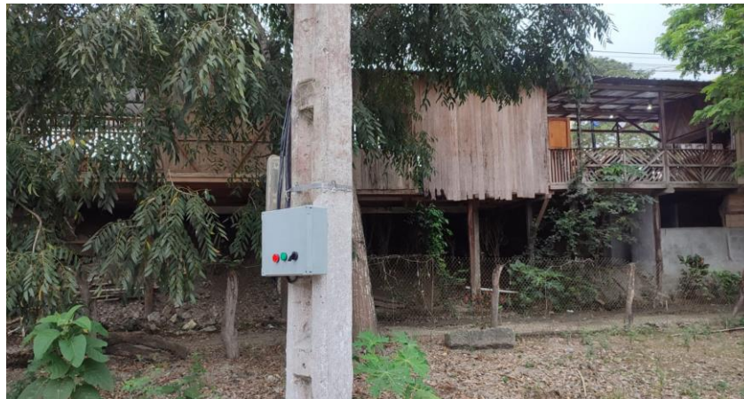
Figura 36 Posición del tablero Eléctrico.
