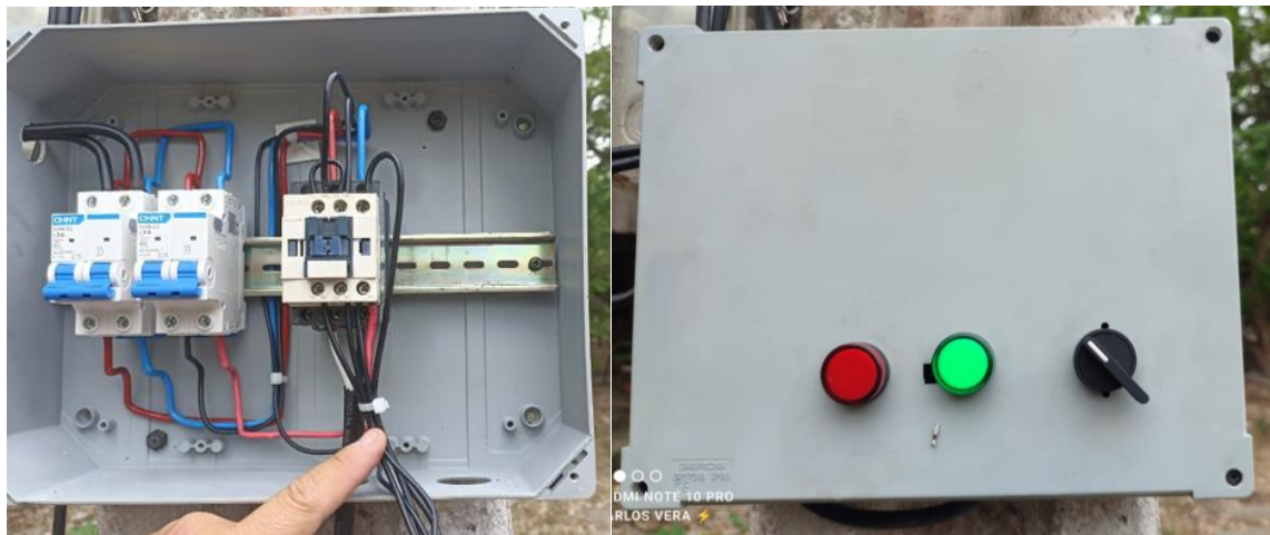
Figura 37 Conexión a la caja de protección.
