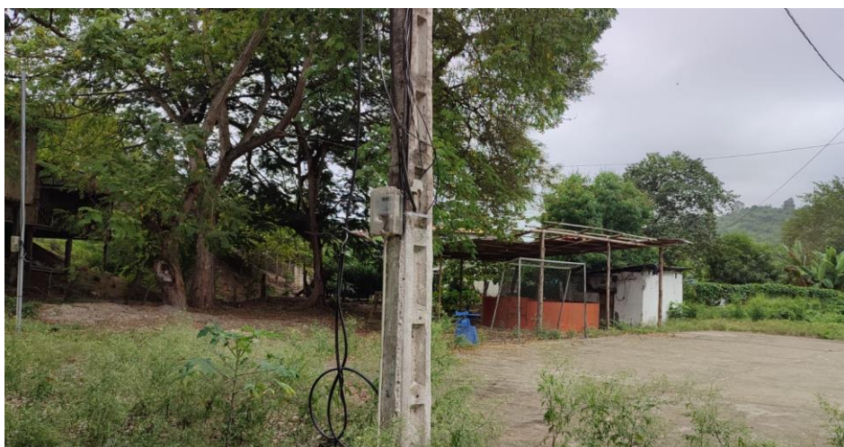
Figura 19. Conductores colgados en el poste.
