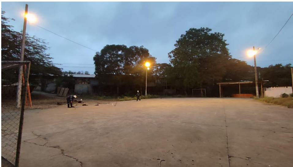
Figura 38 Resultado del Sistema de Iluminación.
