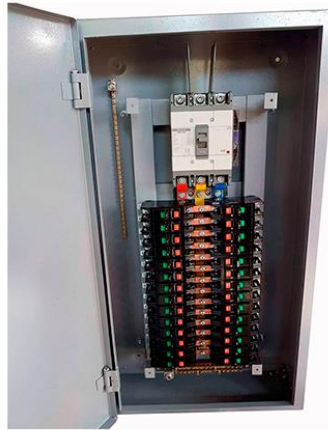
Figura 3. Tablero de distribución
