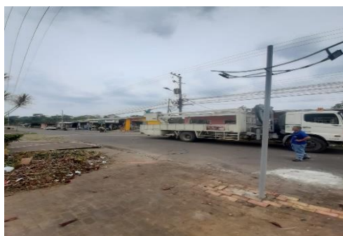
Figura 58. Caja térmica energizada por parte de la empresa eléctrica CNEL E.P
