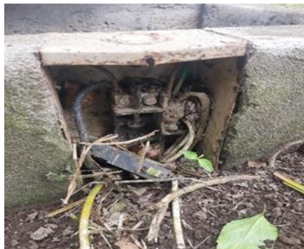
Figura 28. Caja de distribución en estado actual
