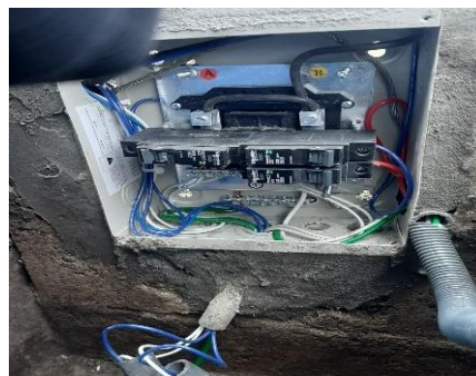
Figura 57. Caja termia lista para ser energizada
