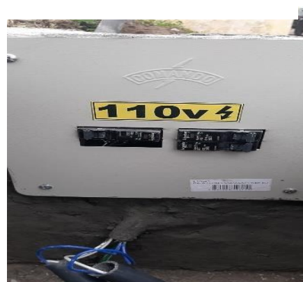
Figura 59. Caja térmica energizada
