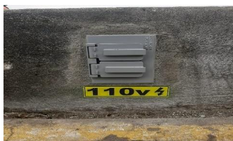
Figura 55. Tomacorriente para exteriores
