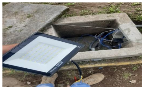
Figura 54. Luminarias listas para ser instaladas
