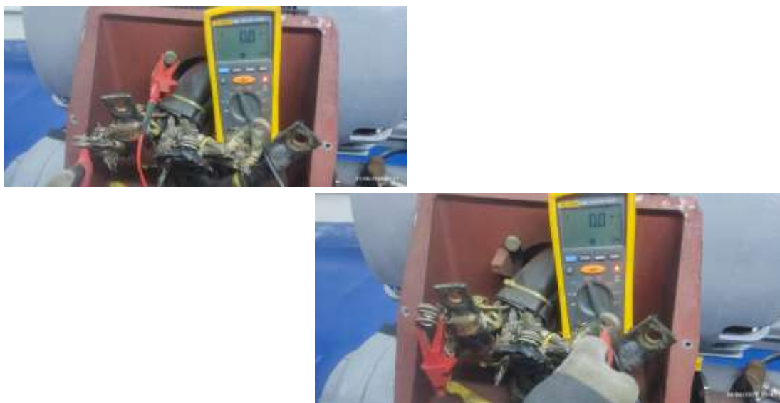
Fig. 18 Medición de resistencia a motor Jausin
