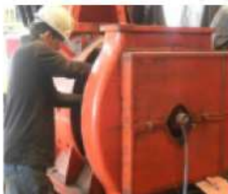
Fig. 1: revisión de fallas de aislamientos
