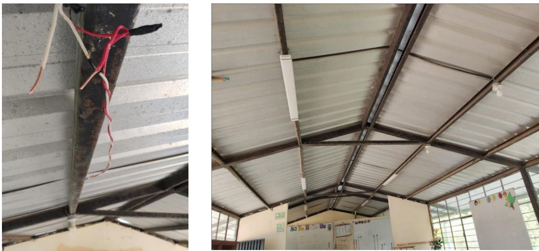
Figura 47. Cableado de circuitos
