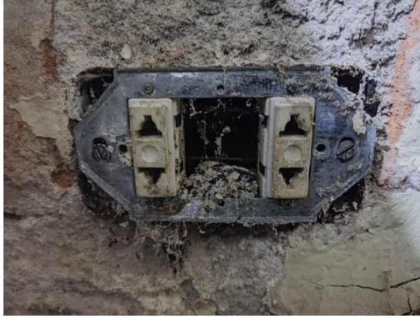
Figura 22. Tomacorrientes en mal estado.
