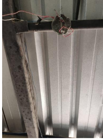
Figura 24. Deficiencia de tubería en el cableado de iluminación.
